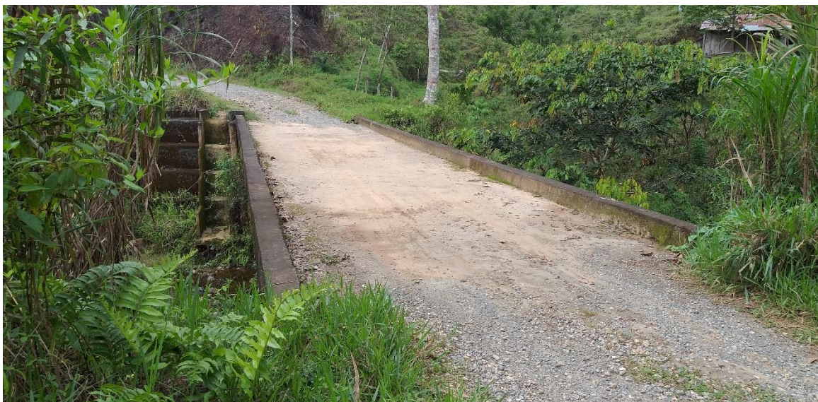
Puente existente angosto y sin barandas de seguridad
