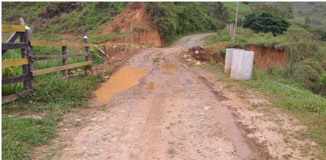
Estrechamiento de la vía por deslizamiento de tierra
