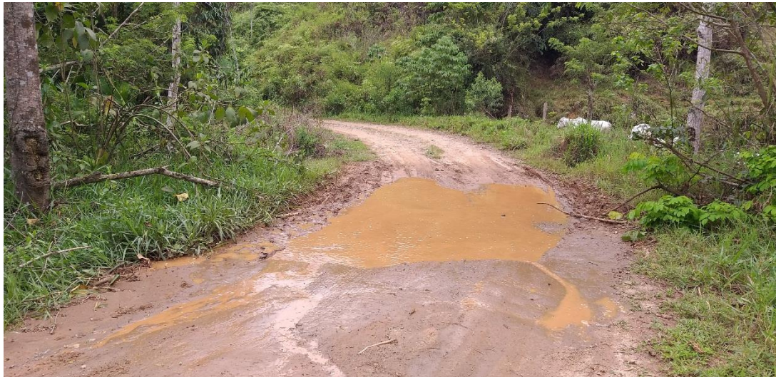
Punto crítico acumulación de agua por falta de obras de drenaje
