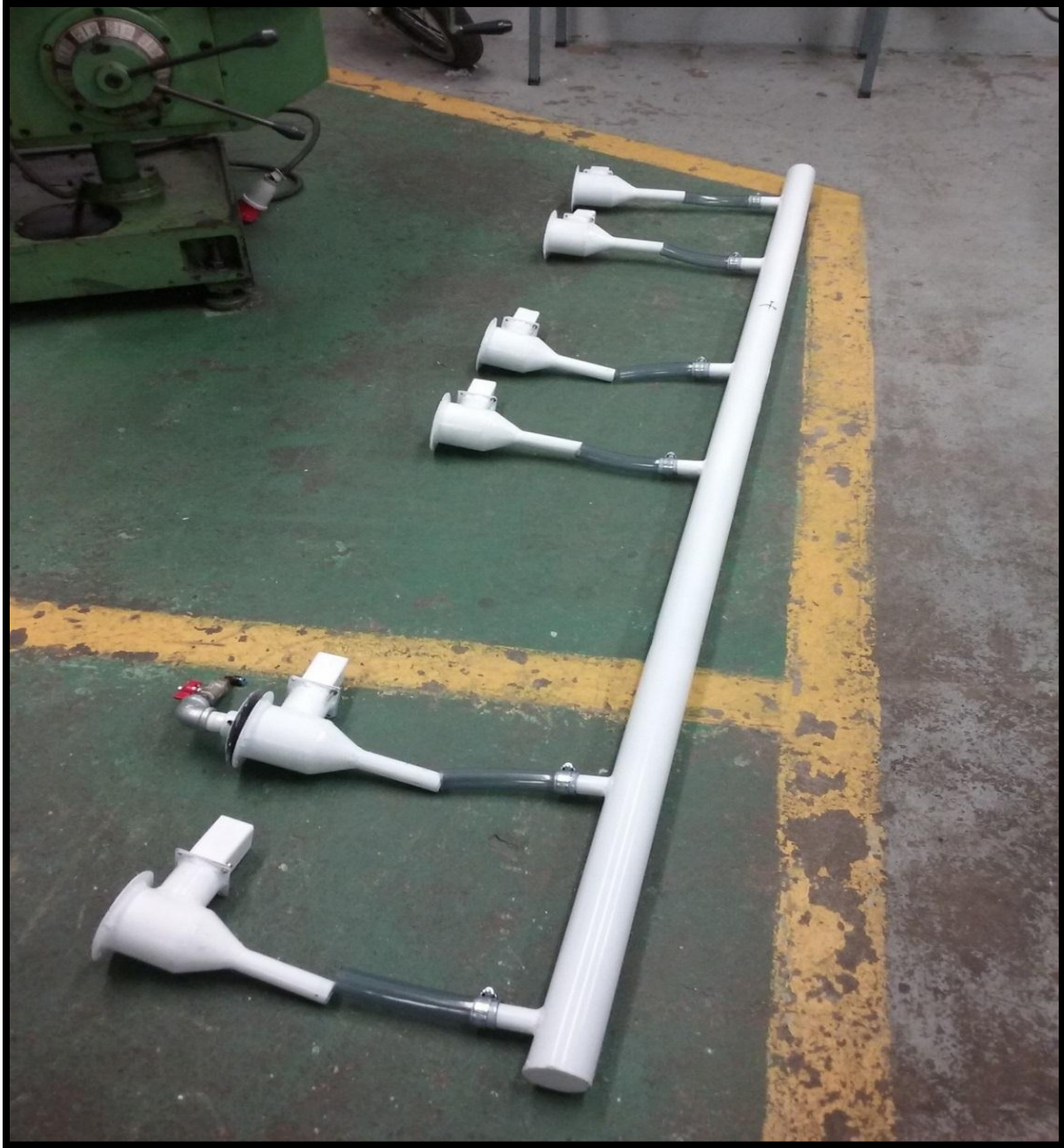
Figura 26. Eyectores y ductos pintados
