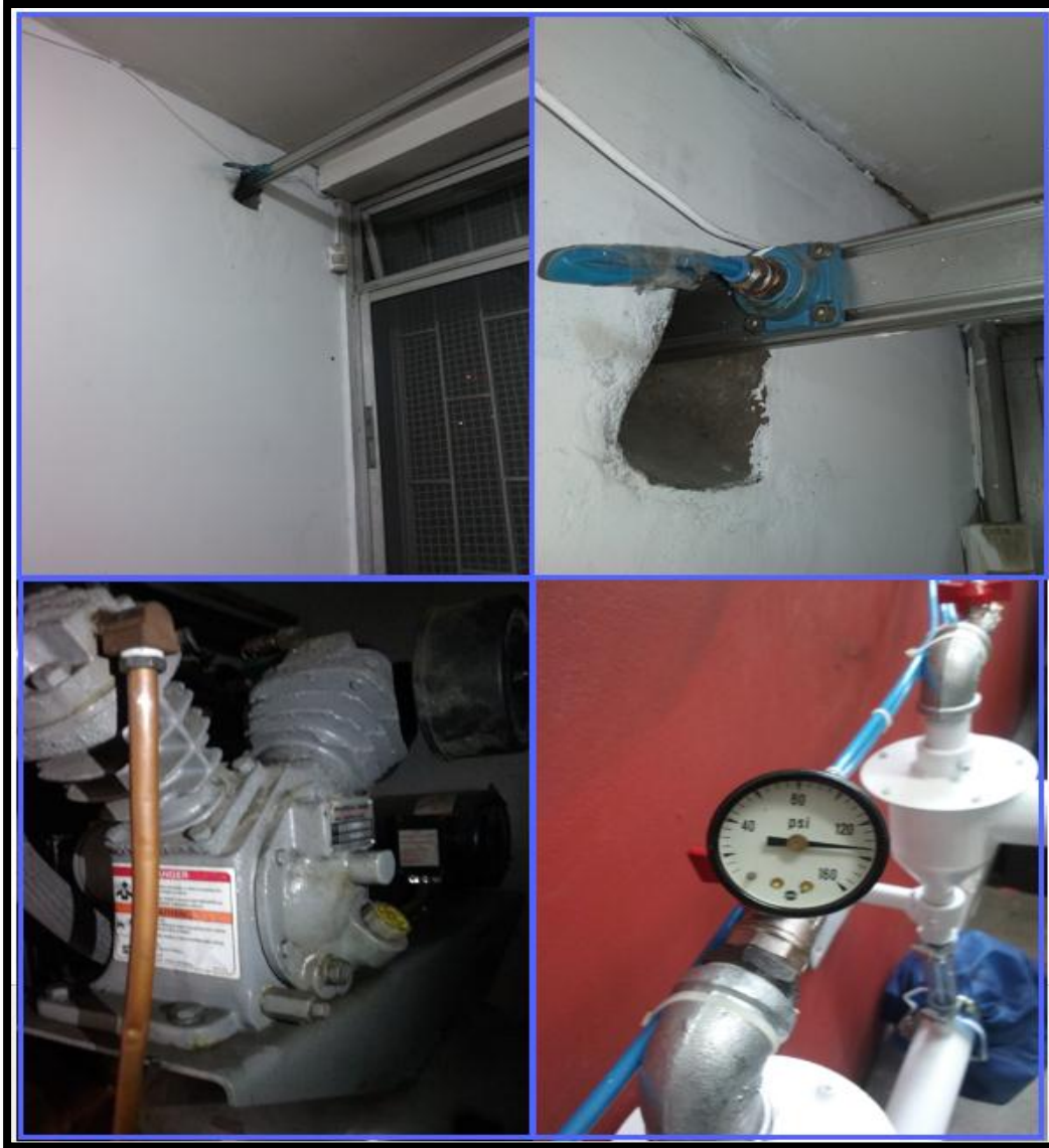
Figura 34. Ubicación toma de aire y verificación de presión
