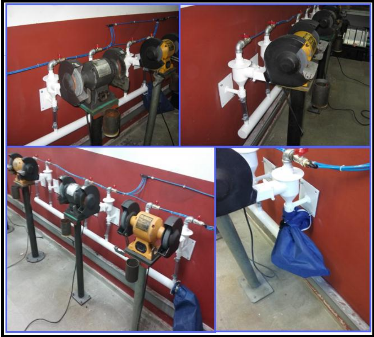
Figura 35. Montaje final sistema de eyectores Fuente: Institución Universitaria Pascual Bravo
