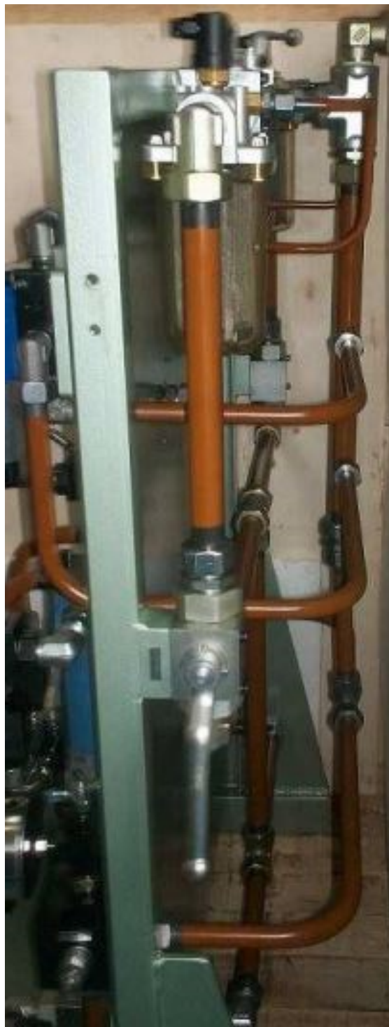
Foto 3. Unidad hidráulica de potencia
