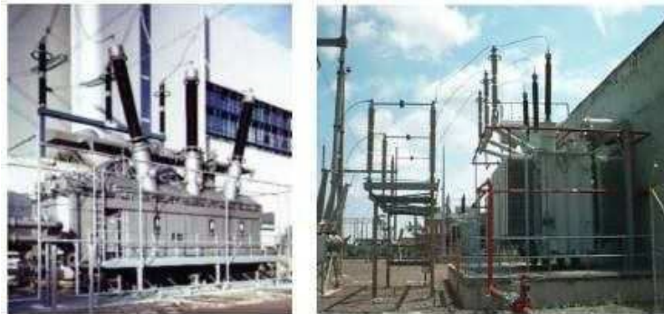
Figura 15. Transformadores de potencia.
