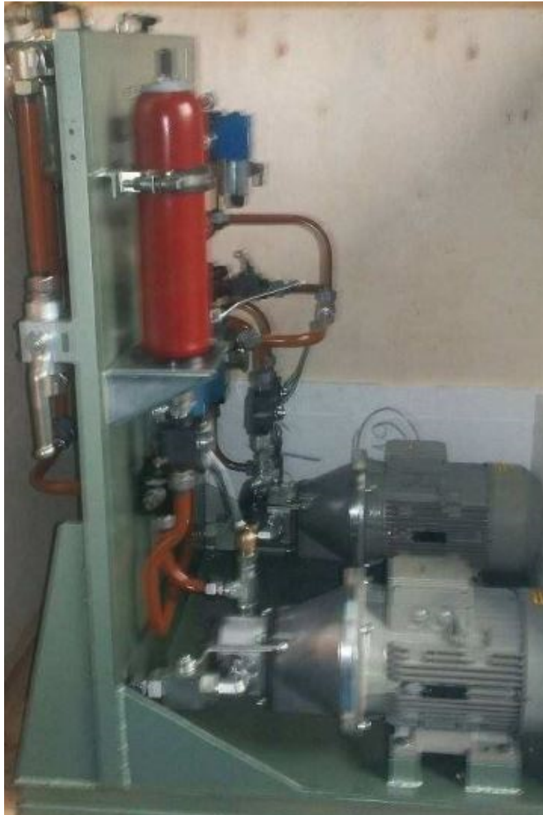
Foto 2. Unidad hidráulica de potencia
