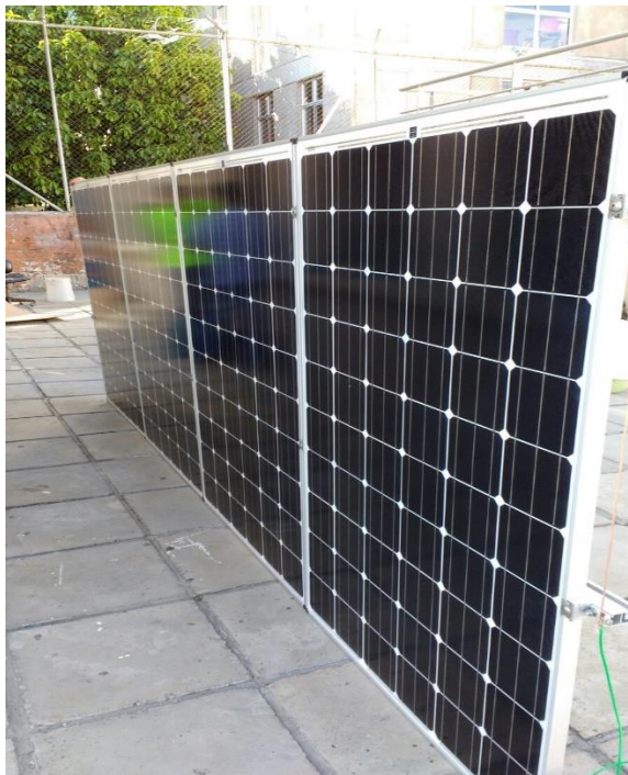
FIGURA 14. Paneles solares acoplados
