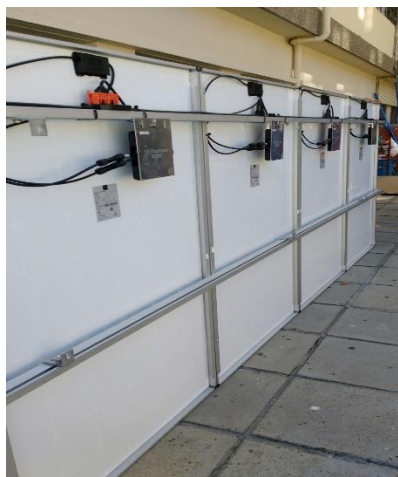
FIGURA 17. Micro inversores instalados
