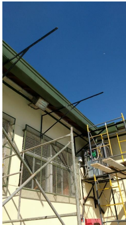
FIGURA 13. Ubicación de los paneles solares (fotovoltaicos)
