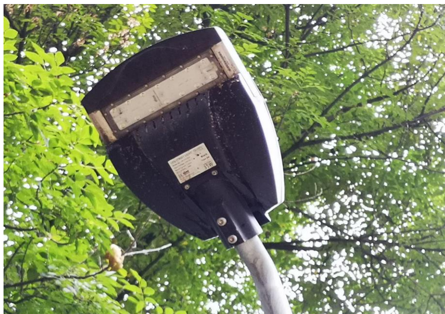
Figura 12. Luminarias existentes. Fuente. Propia
