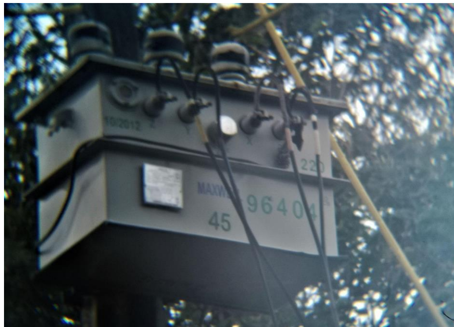
Figura 20. Transformador de distribución.
