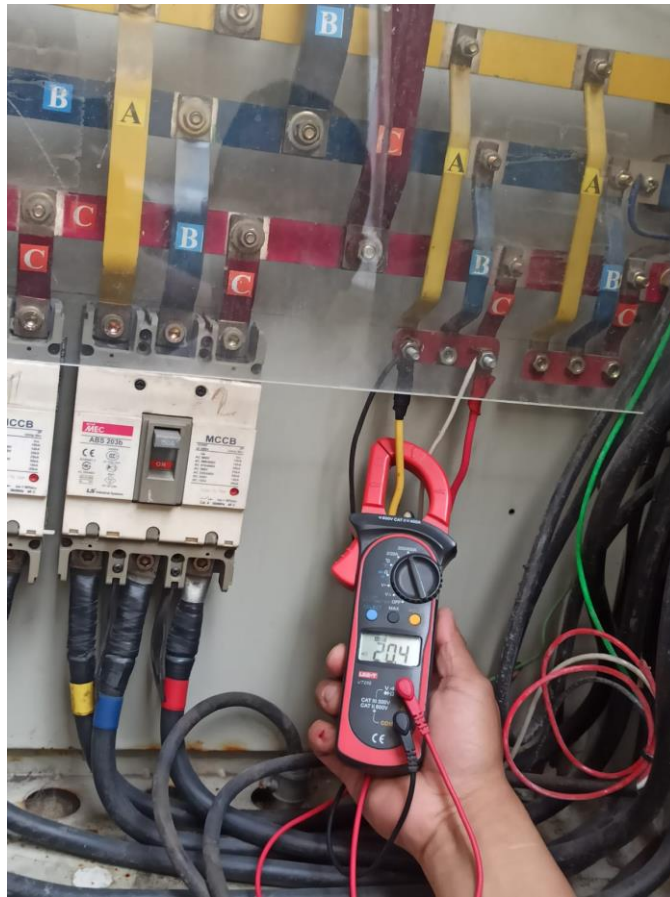
Figura 12. Falta protección eléctrica en tablero ML A.A
