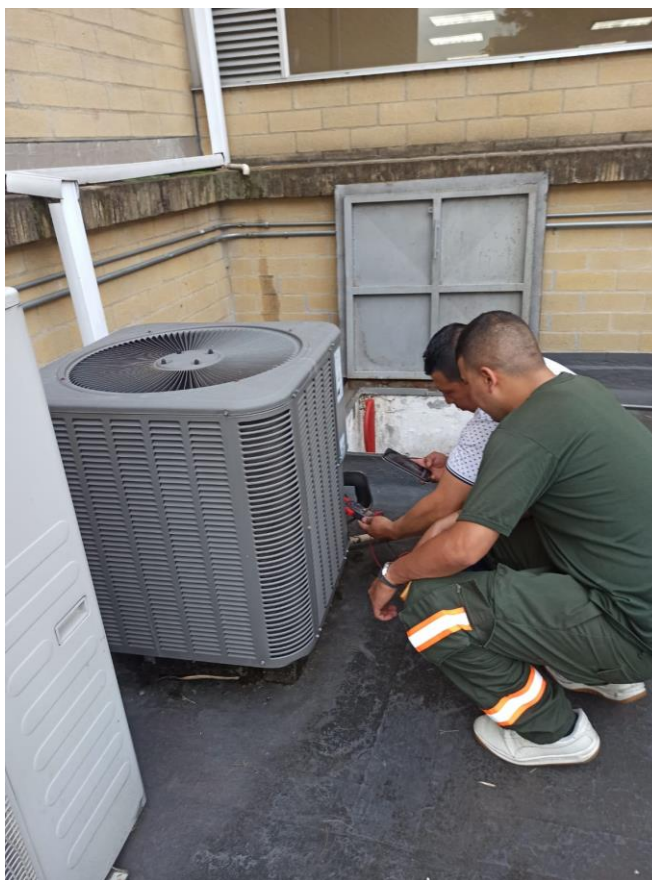
Figura 20. Equipo de A.A de la biblioteca Fuente: propia
