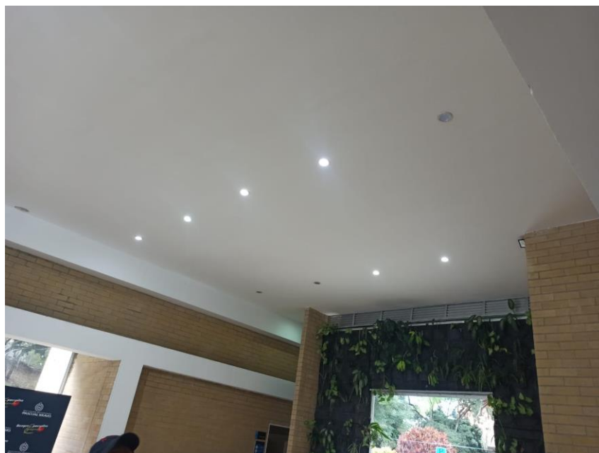
Figura 35. Falta de mantenimiento correctivo de iluminación Fuente: propia
