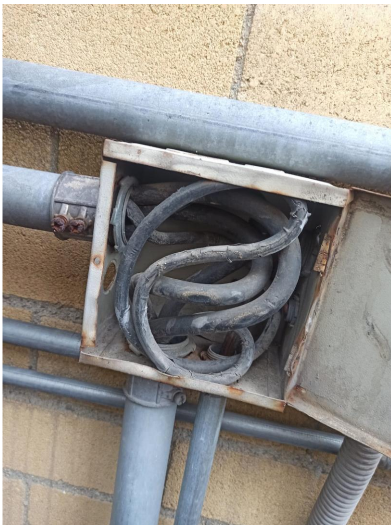
Figura 21. Cajas de paso en alimentación de A.A
