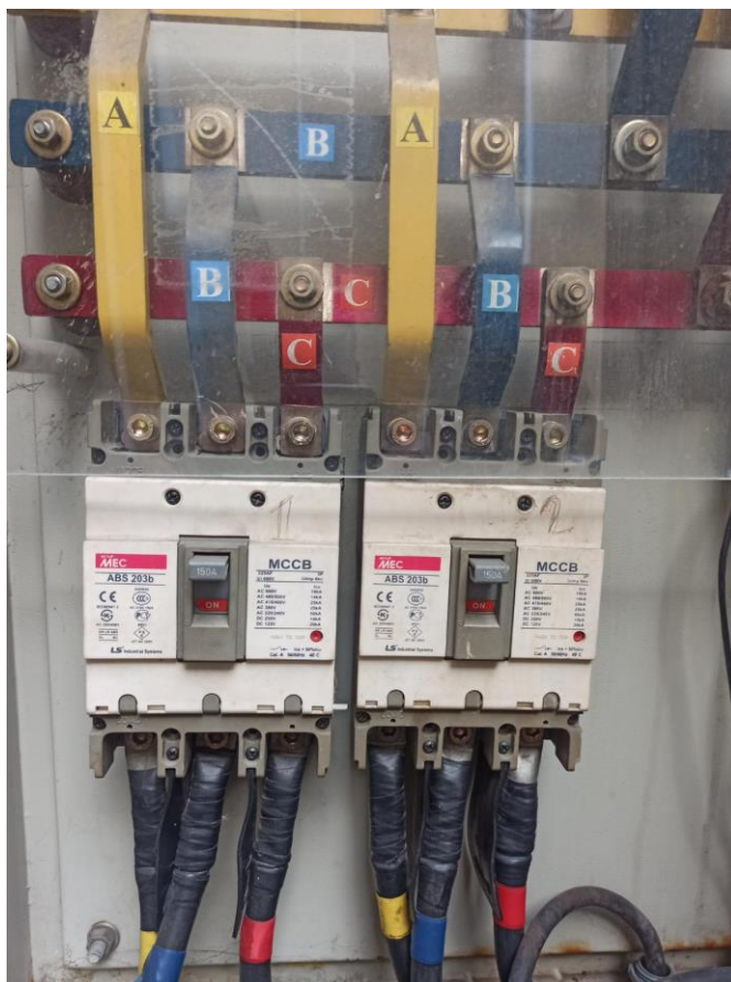
Figura 13. Falta marcación protecciones de ML A.A
