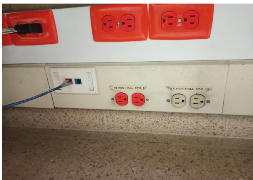
Figura 33. Circuito energía regulada sin identificar Fuente: propia
