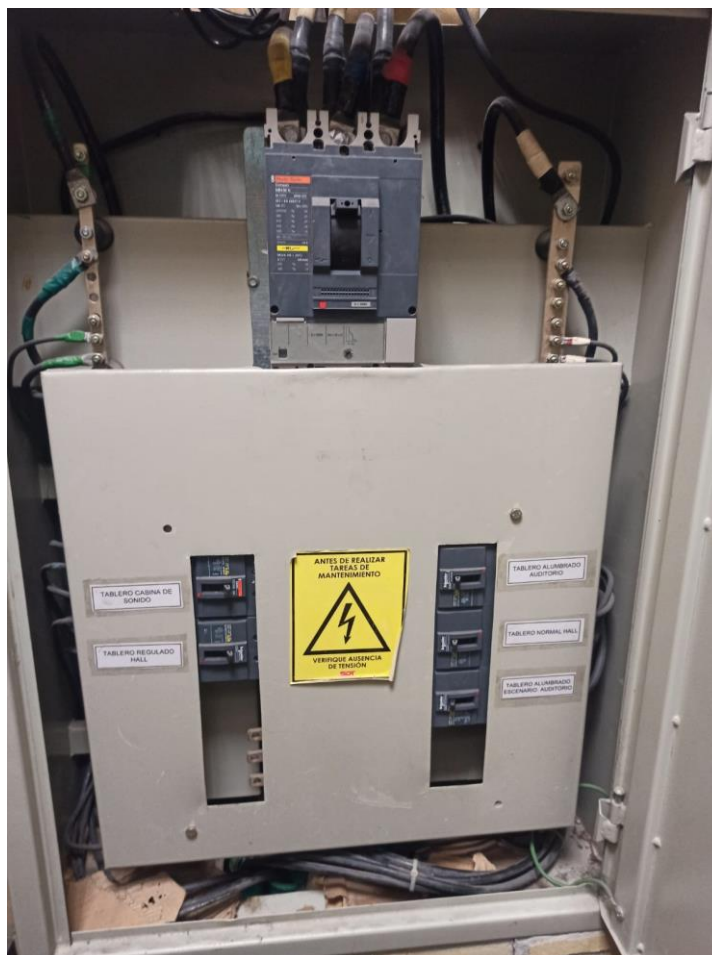
Figura 25. Tablero TGA Auditorio la Convención Fuente: propia
