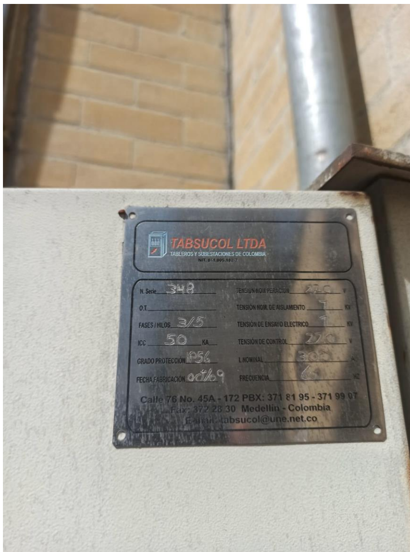
Figura 11. IP del tablero ML de A.A Fuente: propia
