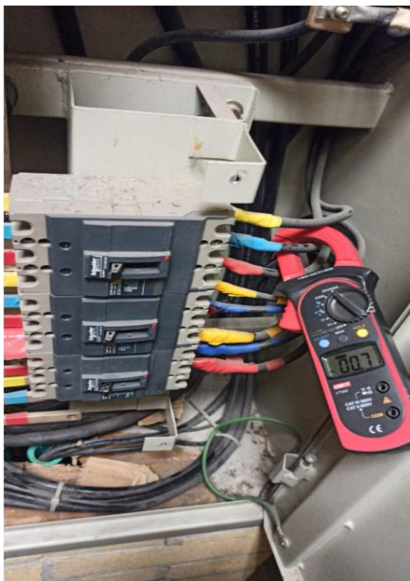
Figura 28. Corriente de tablero alumbrado auditorio Fuente: propia
