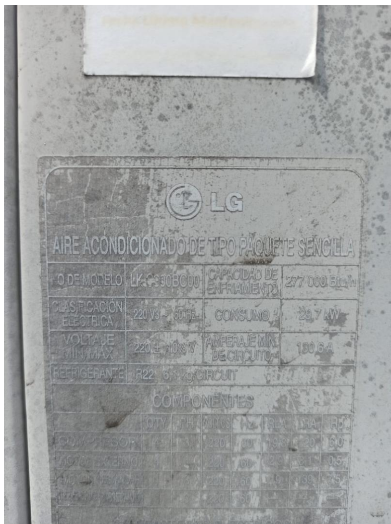
Figura 17. Placa de características equipos de A.A
