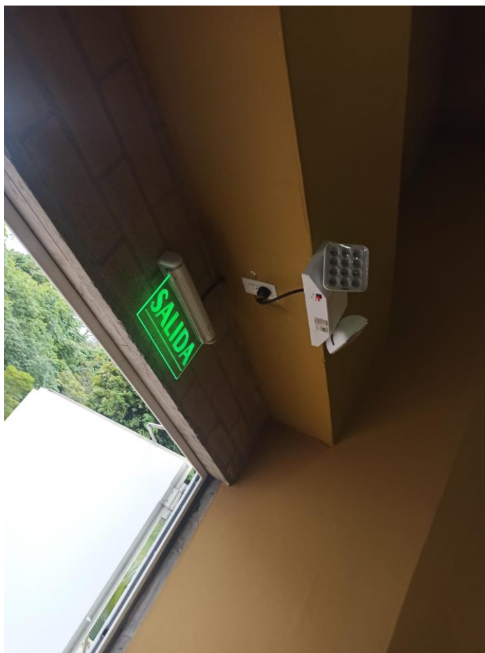
Figura 34. Iluminación de emergencia
