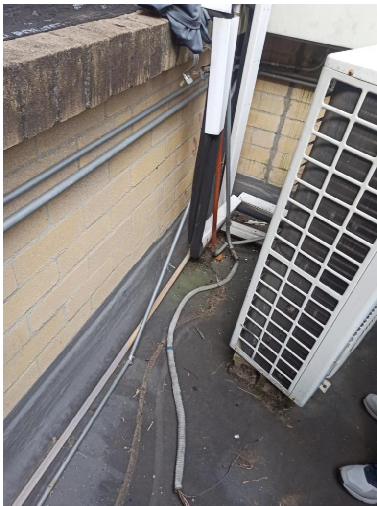
Figura 22. Tubería suelta y en mal estado de las canalizaciones
