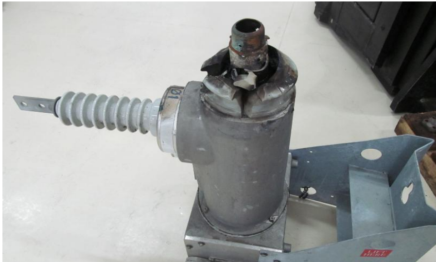
Foto 3. Reconectador monofásico marca JOSLYN fallado
