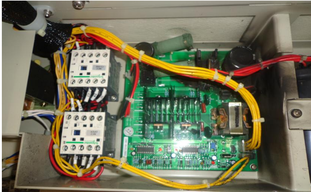
Foto 1. Módulo UPS reconectador ENTEC fallado
