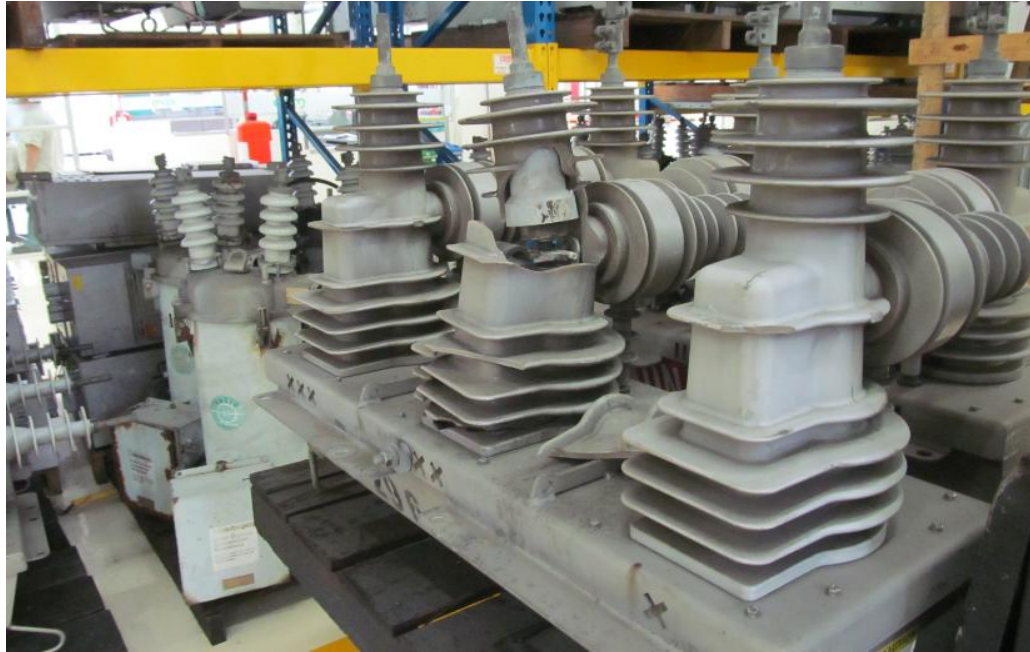
Foto 2. Reconectador trifásico marca NULEC de Schneider Electric fallado.
