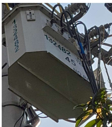
Figura 17. Transformador de 45 kVA del bloque 26. Fuente: Fotografiada por Habib Geliz y Daniel Villa
