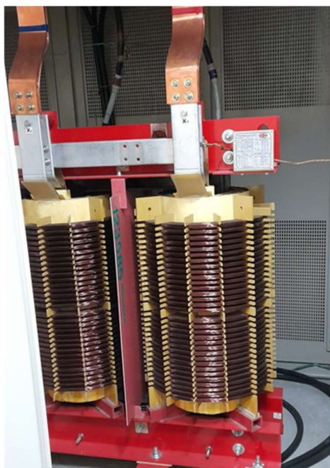
Figura 16. Transformador de 500 kVA del bloque 25. Fuente: Fotografiada por Habib Geliz y Daniel Villa
