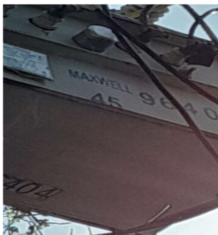
Figura 18. Transformador de 45 kVA de la cancha de futbol. Fuente: Fotografiada por Habib Geliz y Daniel Villa
