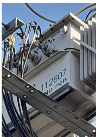
Figura 19. Transformador de 150 kVA del bloque 19. Fuente: Fotografiada por Habib Geliz y Daniel Villa
