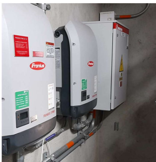
Figura 27. Inversores de 22.7 kW del bloque 6. Fuente: Tomada por Habib Geliz y Daniel Villa
