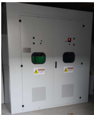
Figura 20. Transformador de 1000 kVA del bloque 6. Fuente: Fotografiada por Habib Geliz y Daniel Villa
