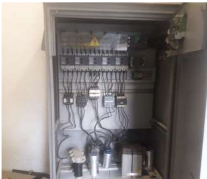
Figura 22. Banco de condensadores.
