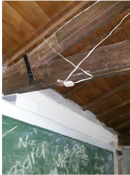
Ilustración 6 Cable sin tubería
