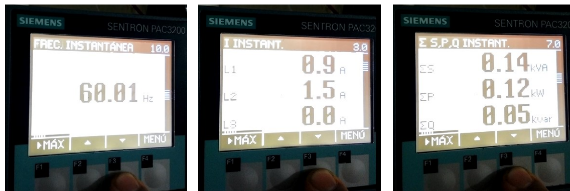
Foto 6. Multimetro instalado en el tablero de distribución de la empresa Pizzelino
