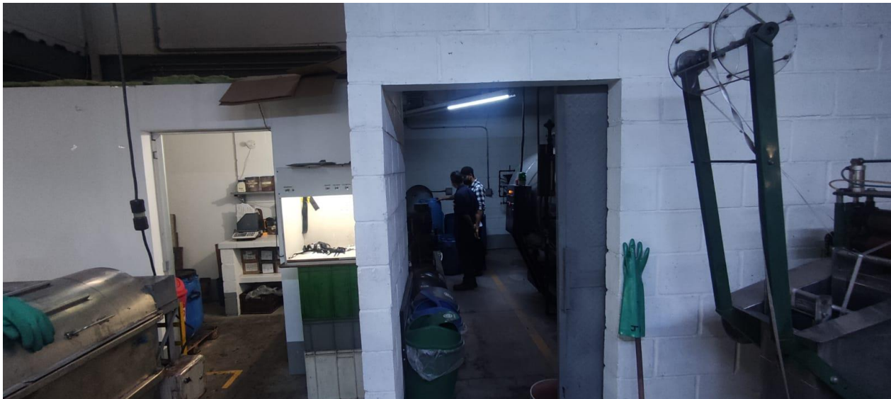
Ilustración 8 Zona de Químicos y Zona de Calderas PROSALTEX S.A.S.
