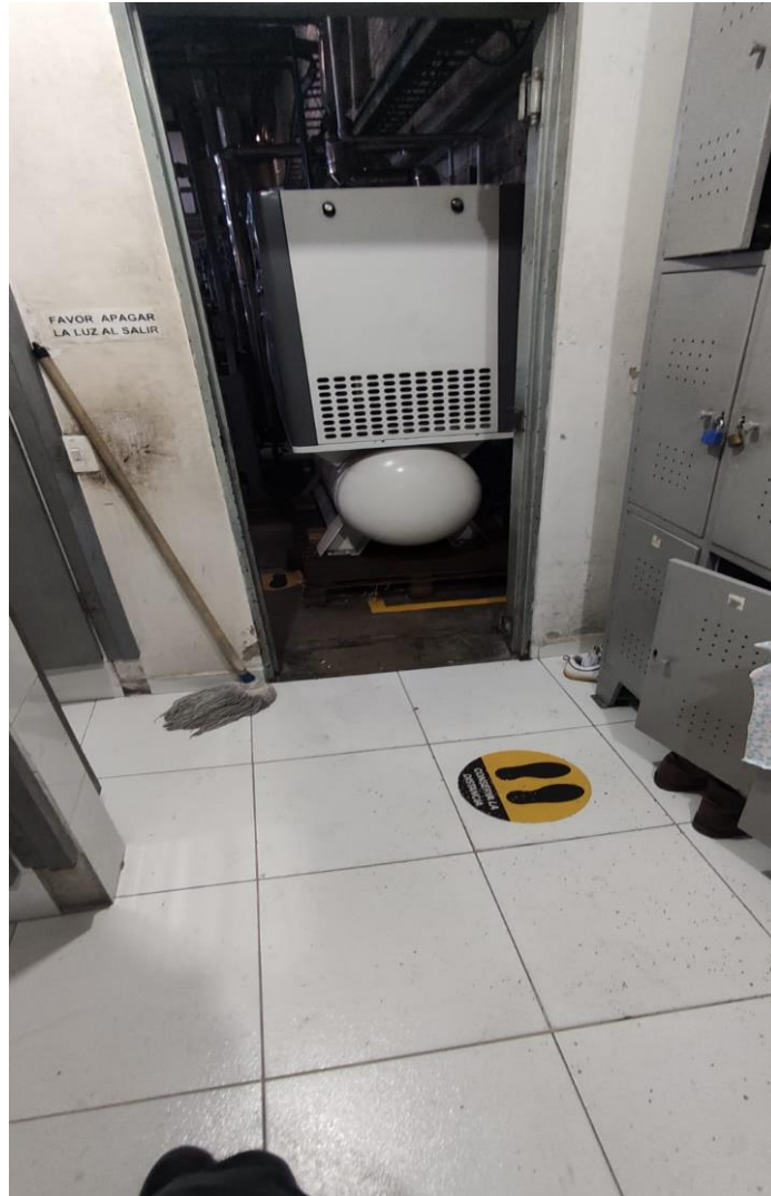
Ilustración 6 Compresor, vista interior en baños PROSALTEX S.A.S
