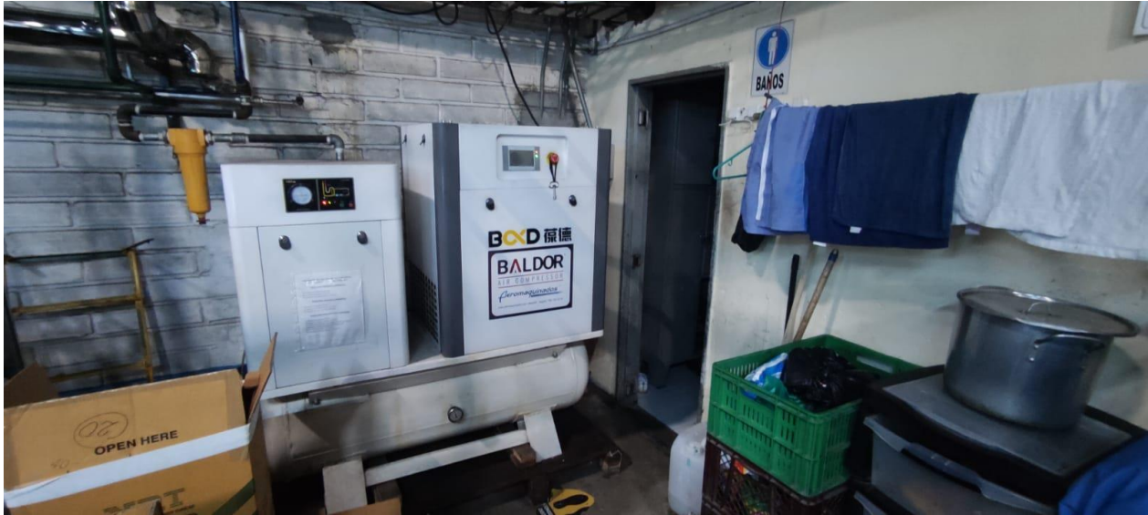
Ilustración 7 Compresor, vista exterior baños PROSALTEX S.A.S.
