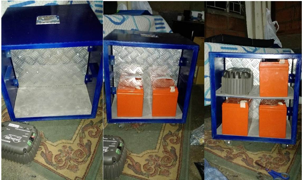
Figura 10 Almacenaje de inversor y baterías
