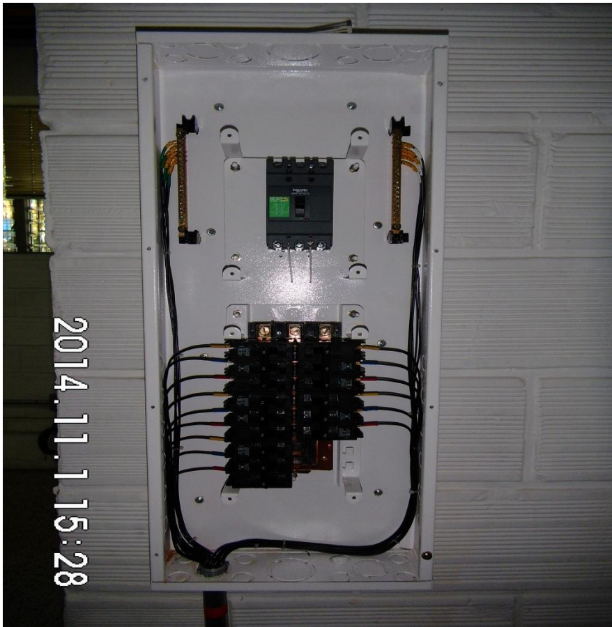
Ilustración 18. Tablero T3A-105 con protecciones internas.
