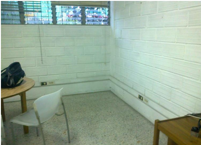
Ilustración 14. Instalaciones eléctricas antiguas aula 105 del bloque 3 A.
