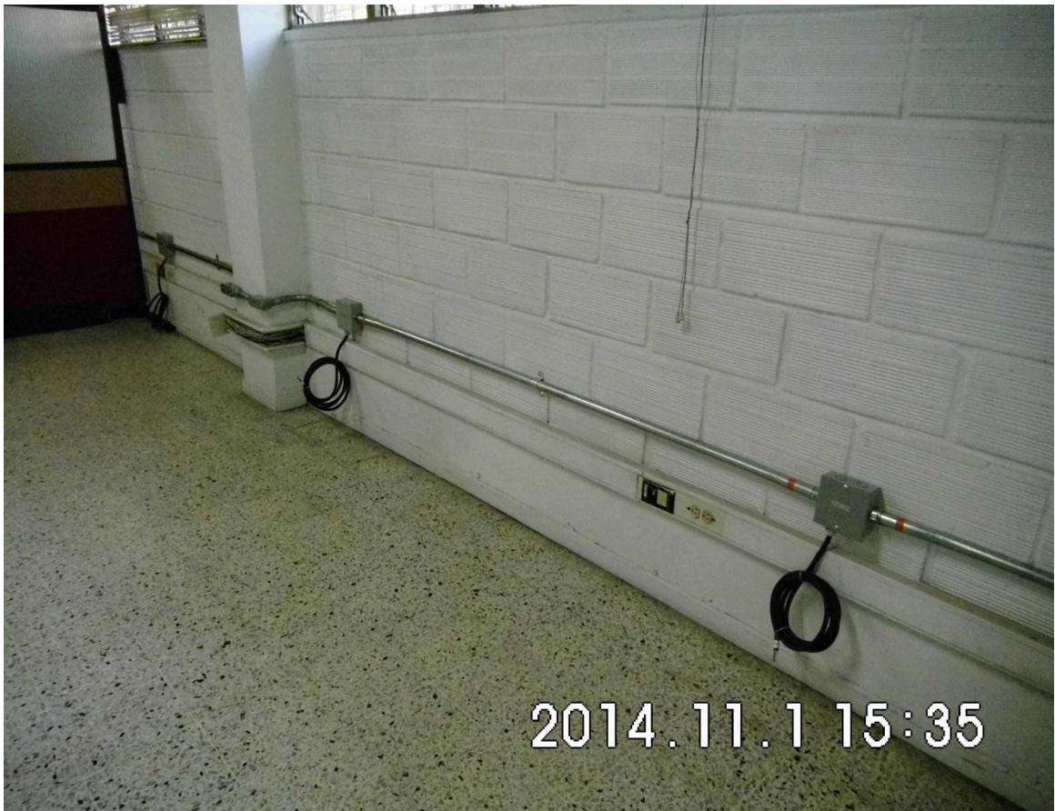
Ilustración 17. Salidas eléctricas expuestas.
