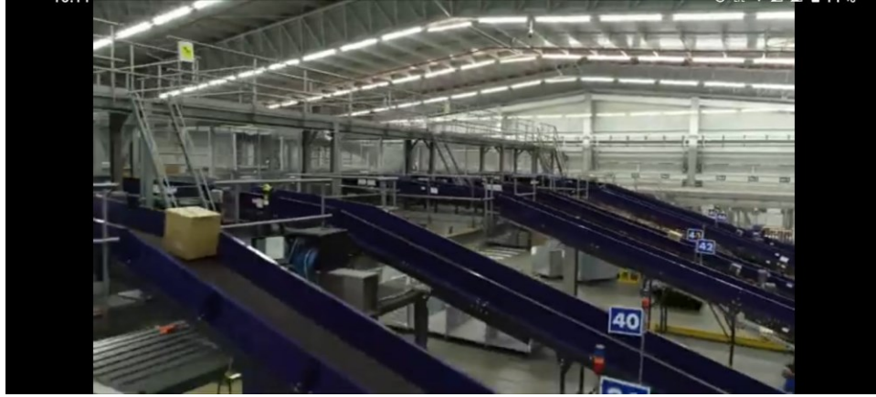
Figura 17. Banda transportadora dentro de la bodega de Coordinadora.
