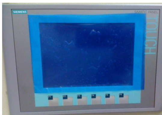
Figura 14. Pantalla HMI KTP 600 Siemens.
