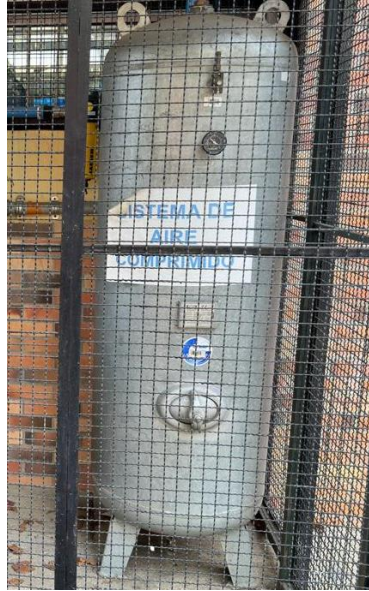
Figura 41 Tanque de almacenamiento de aire comprimido de la I.U. Pascual Bravo.
