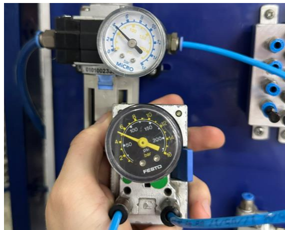
Figura 35 Manómetro con lectura incorrecta.
