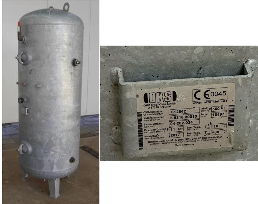
Figura 5 Tanque de almacenamiento de aire comprimido de la marca OKS Otto Klein GmbH.
