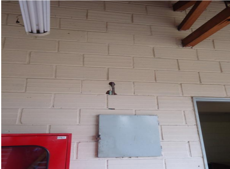
Figura 17. Tablero principal de alimentación de energía bloque 3A.
