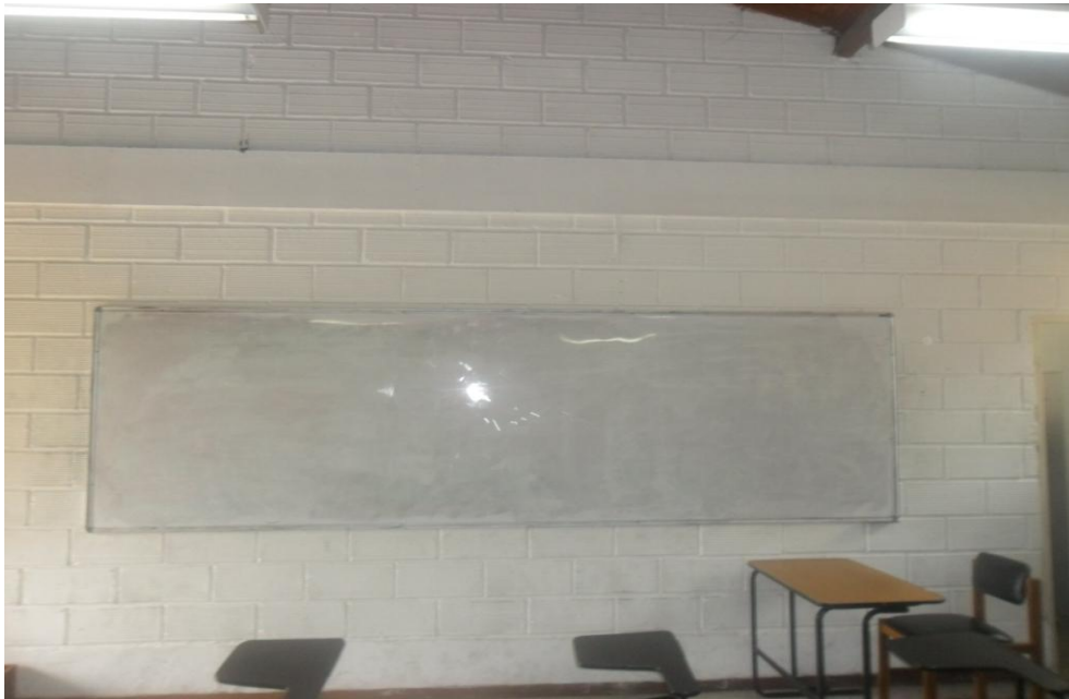
Figura 13. Estado inicial del salón.
