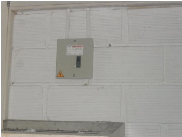
Figura 18. Tablero de circuitos del salón 3A-109
