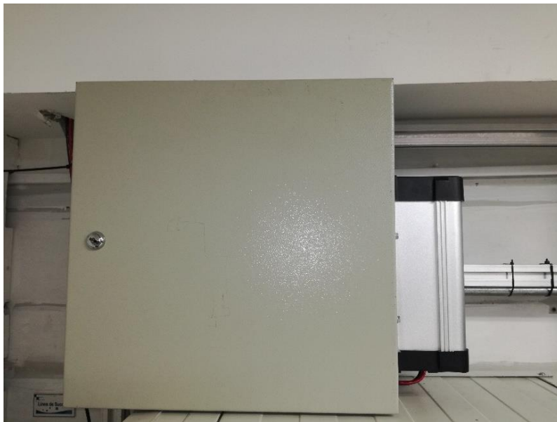
Ilustración 28. Gabinete tablero de potencia.
