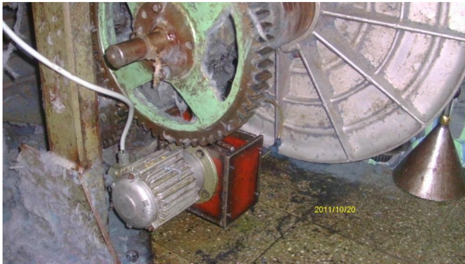
Fotografía 9 caja reductora propuesta conectada a la máquina
