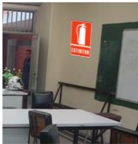
Ubicación extintor clase C
