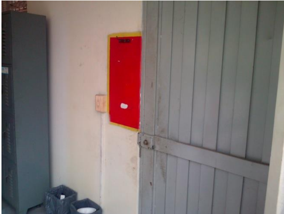
Falta de Extintores
