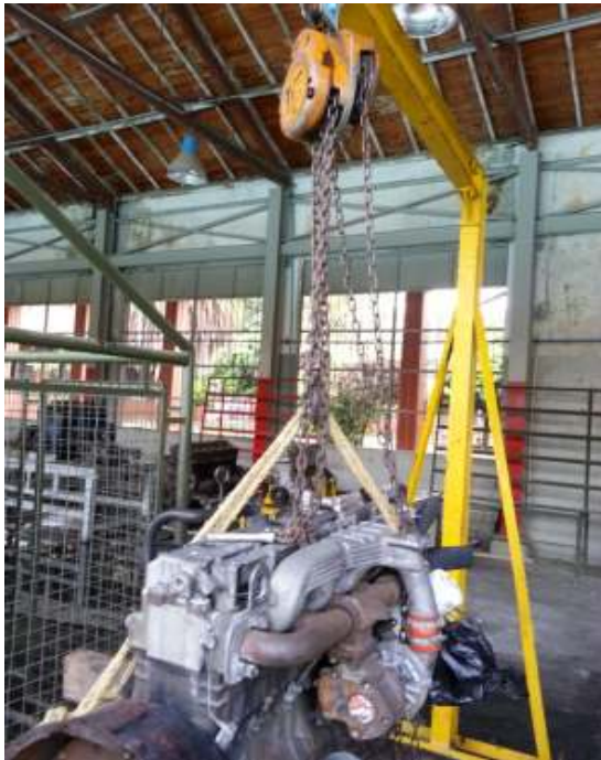
Figura 32 Anclaje de motor.
