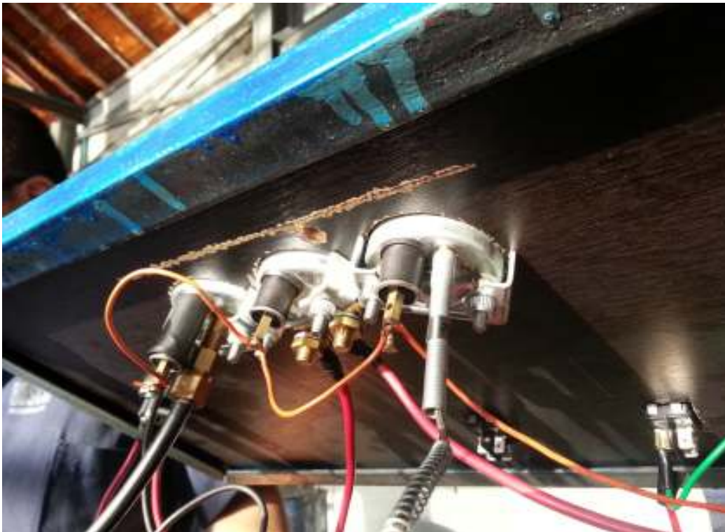
Figura 56 Conexiones electricas y relojes.
