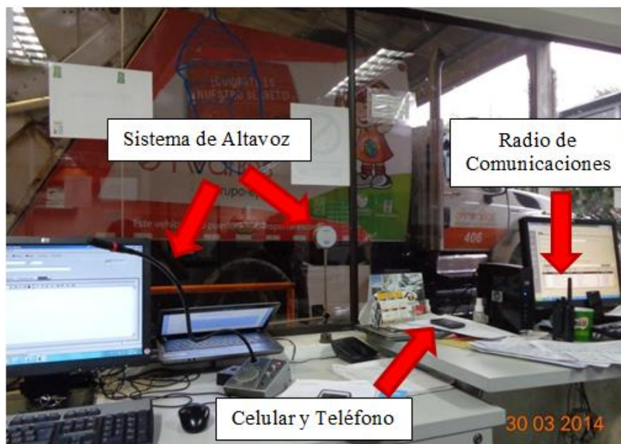
Figura 4. Sistema de Altavoz, Radio de Comunicaciones, Teléfono y Celular (Fuente Emvarias)
