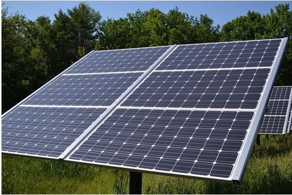
Foto 1 energía fotovoltaica panel solar
