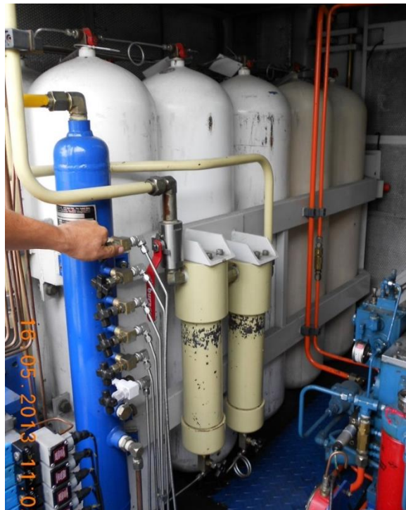
Figura 6, Unidad de almacenamiento (Tomada en la EDS de la 30, 2013) EDS La 30
