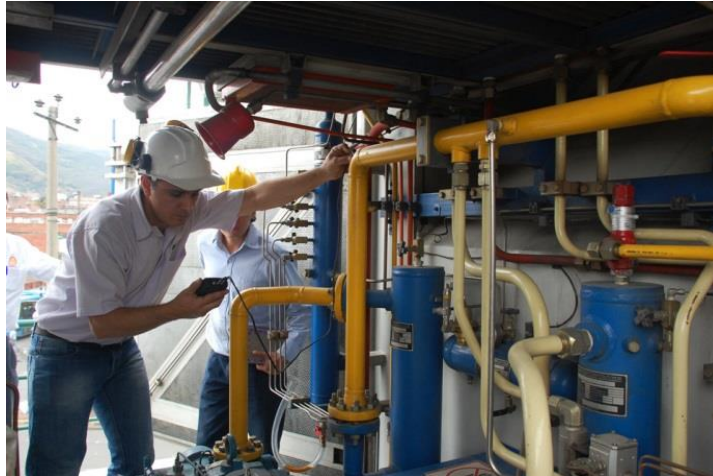
Figura 9. Tuberías de conducción de gas (Tomada en la EDS de la 30, 2014) EDS La 30
