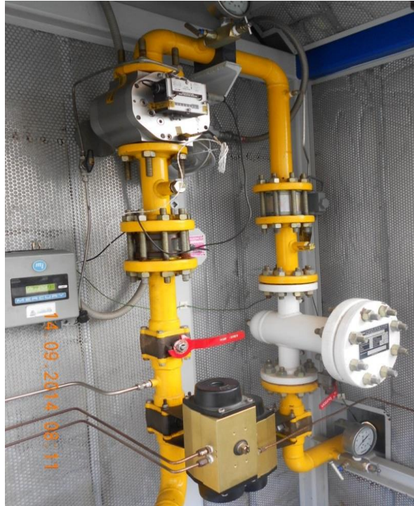
Figura 2. Estación de regulación y medición típica de una EDS con compresor paquetizado (Tomada en la EDS de Mayorca, 2014)
