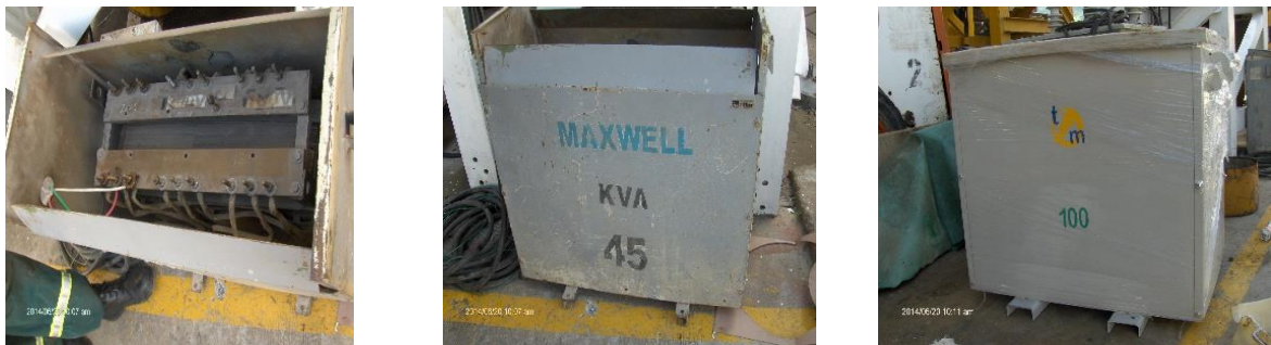
Figura 9. Transformadores de voltaje. Imagen tomada en el sitio (2014).
