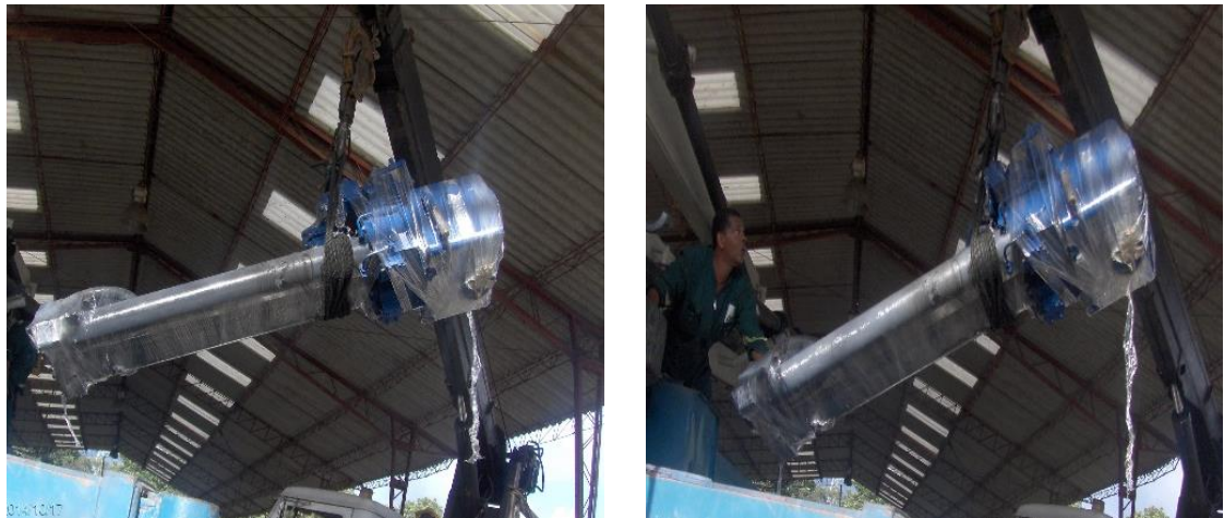
Figura 19. Equipo de bombeo. Imagen tomada en el sitio (2014).
