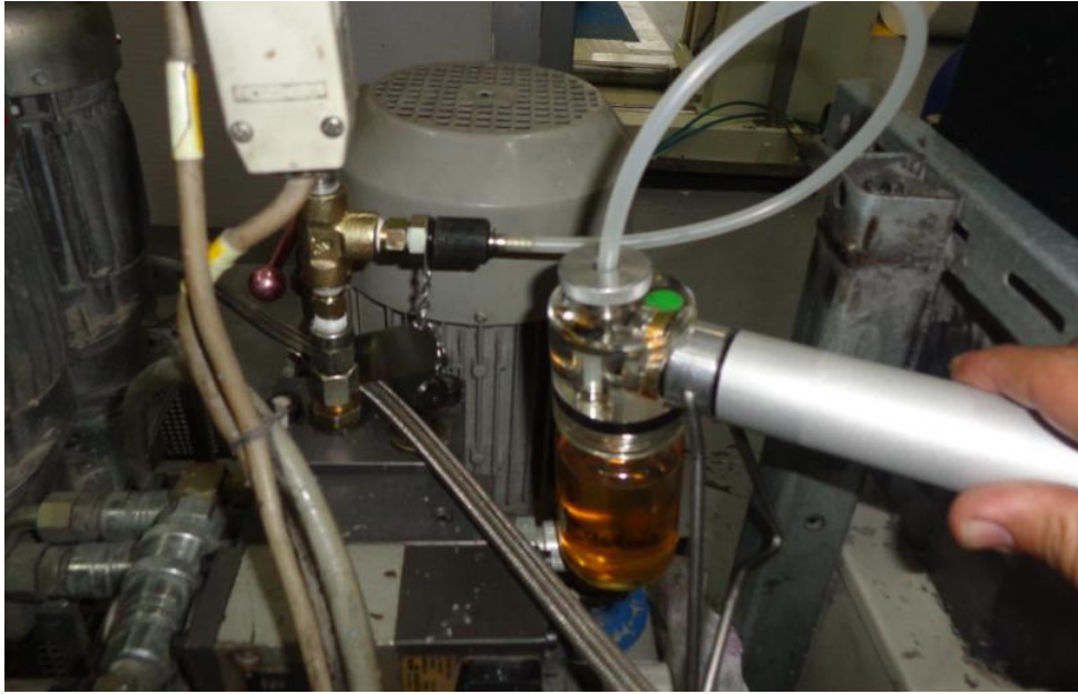
Figura 12. Puerto de muestreo unidad hidráulica
