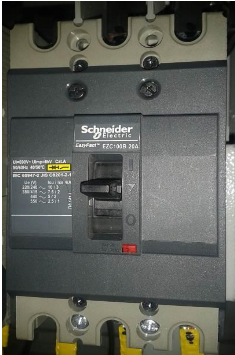
Figura 10 16 . Breaker de Protección Capacitores.
