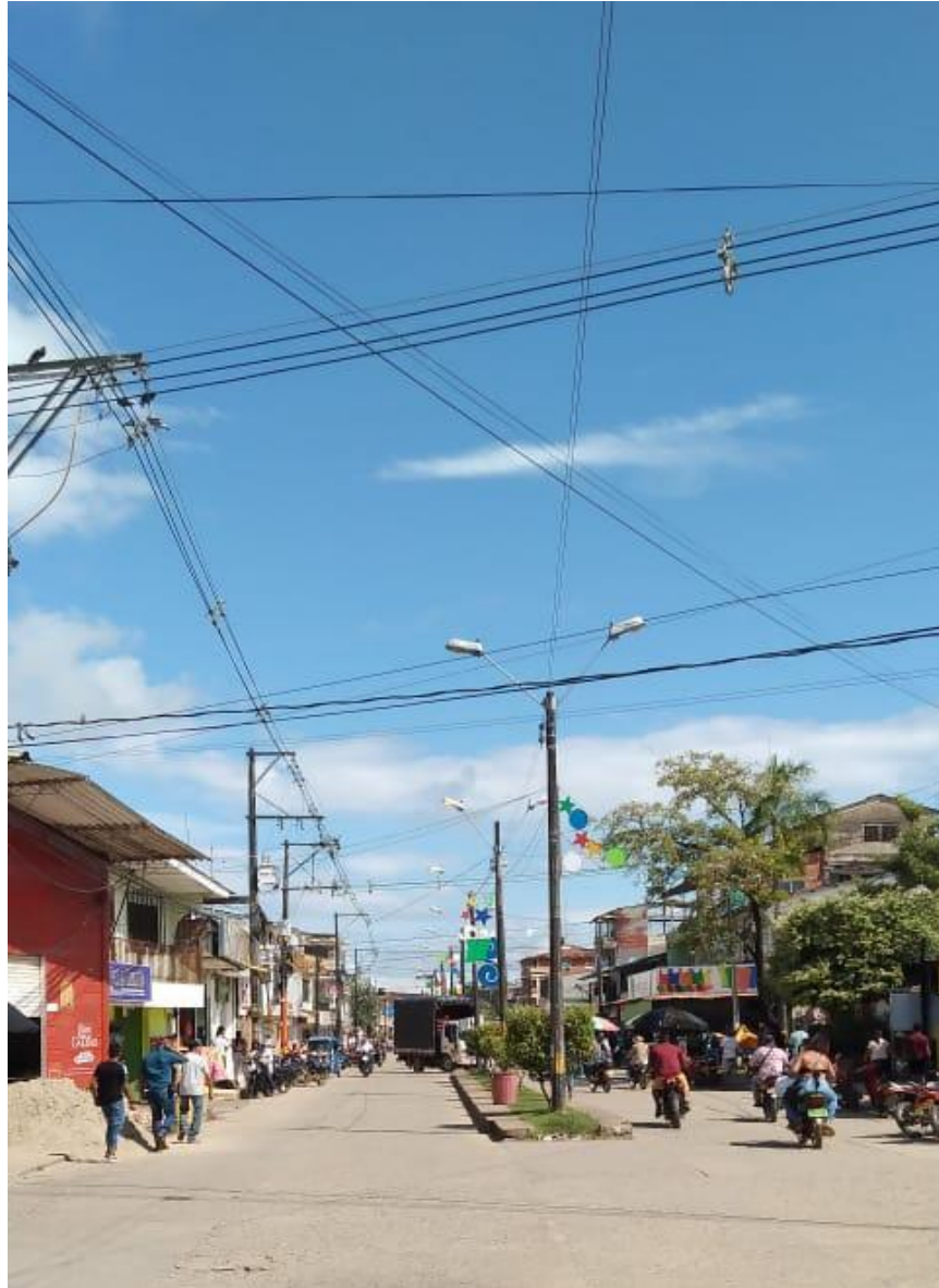
Figura 17. Iluminación tipo central doble (VSP), Carrera 48 El Bagre.
