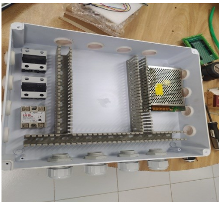
Ilustración 25 Caja eléctrica. Fuente propia
