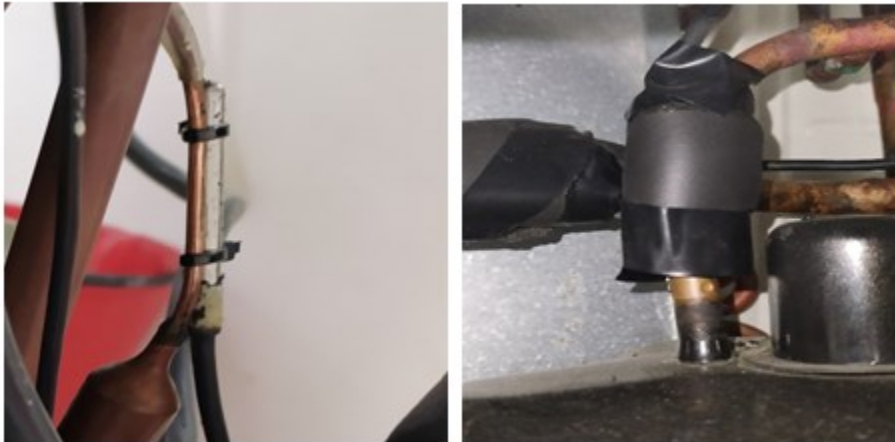
Ilustración 19 Instalación sensor de temperatura. Fuente propia
