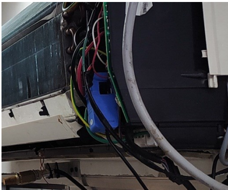
Ilustración 24 Sensor de corriente línea de motor ventilador del evaporador. Fuente propia
