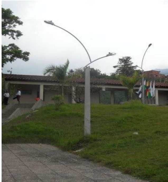
Figura 20. Detalle luminaria plazoleta
