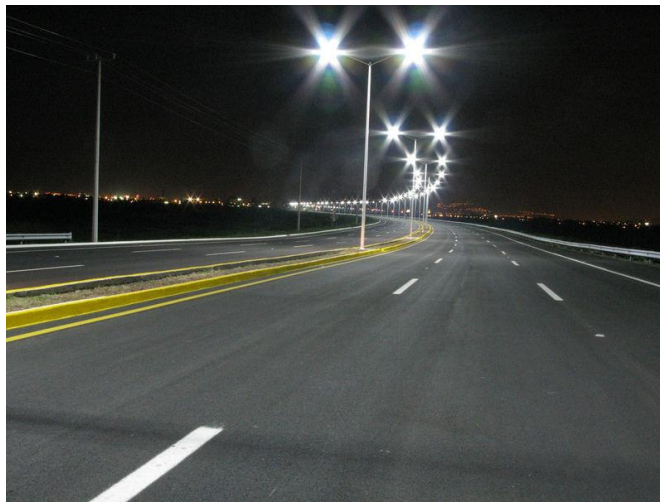
Figura 18. Autopista 2 con luminarias tipo LED.
