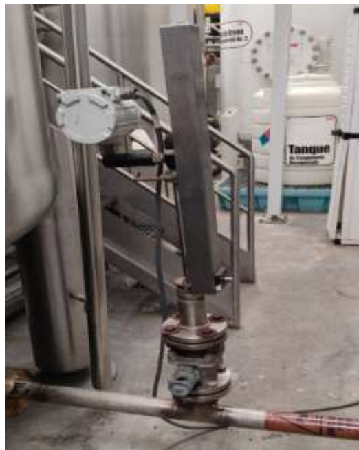
Figura 18. Control PID Fuente: imagen tomada del archivo instalación lazo de control en ptap planta Medellín
