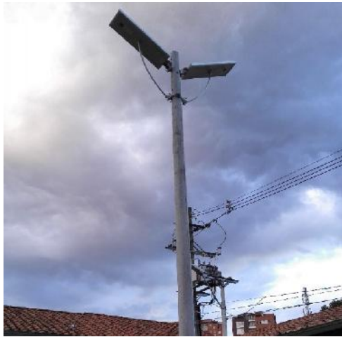
Figura 17. Luminarias a monitorear referencia FHPVS40
