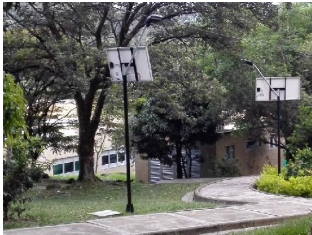
Figura 16. Luminarias a monitorear referencia DP-STL35H
