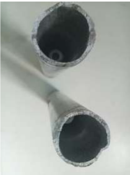
Figuras 16-31 Fractura tubería 3 con soldadura vista interna
