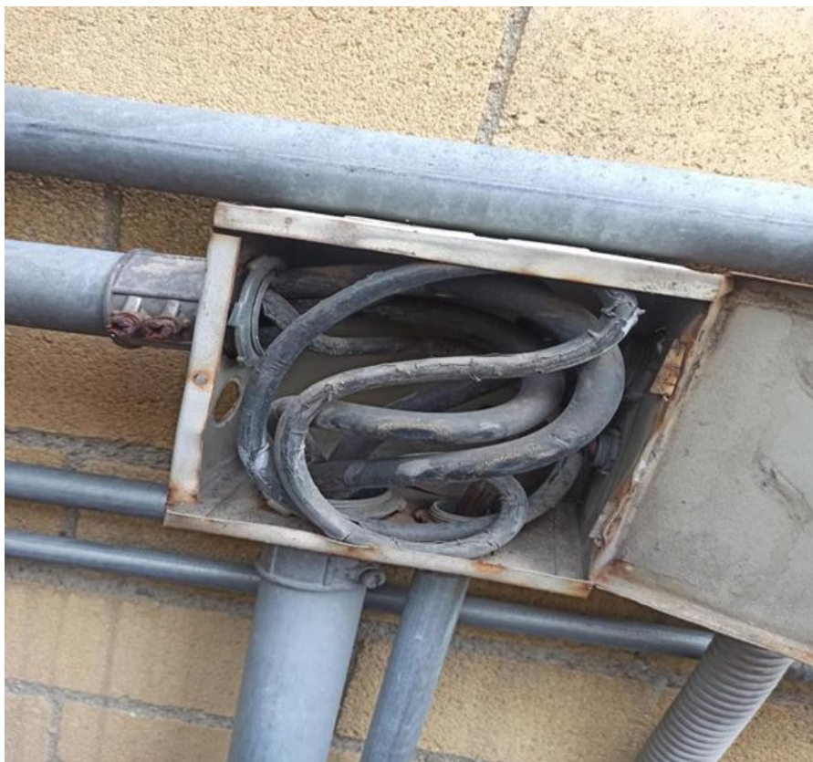
Figura 15. Cajas de paso de alimentación de Aire Acondicionado Bloque 25 (Administrativo) Fuente: diseño propio
