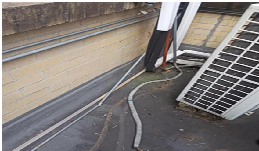
Figura 16. Tubería suelta e inapropiada Fuente: diseño propio
