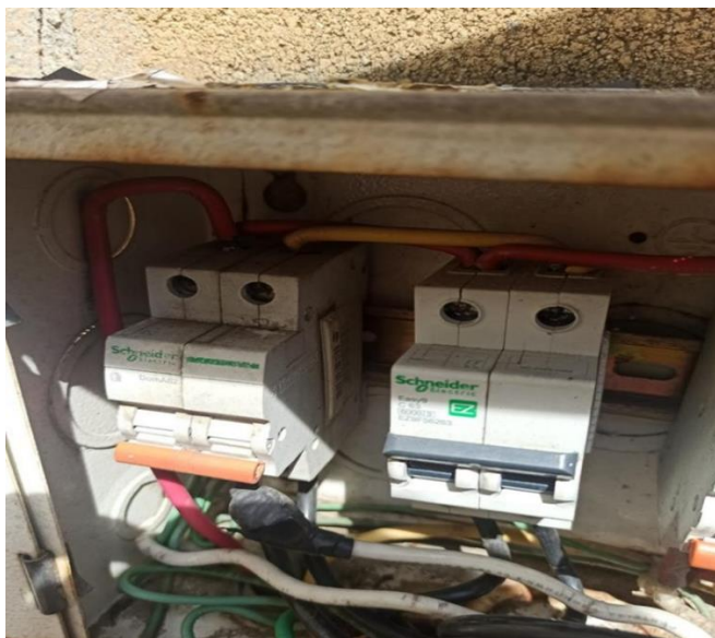
Figura 12. Caja de breaker desde ML Aire Acondicionado (Con Observaciones)
