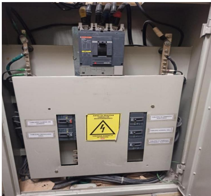
Figura 18. Tablero TGA Bloque 25 (Administrativo)
