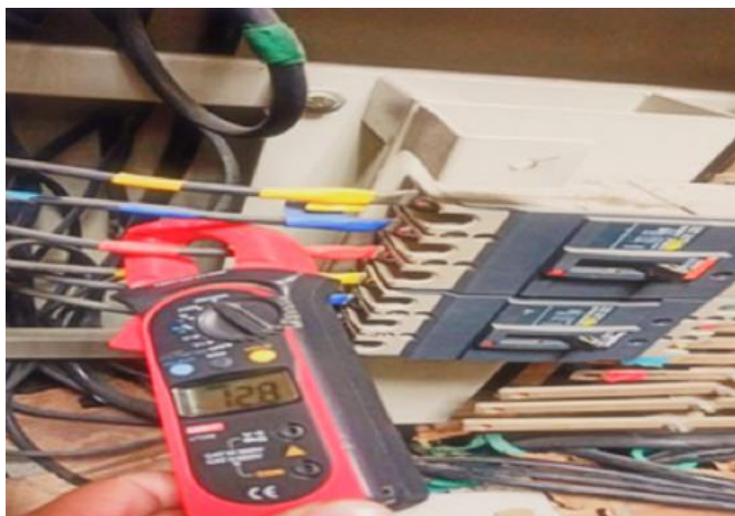
Figura 19. Tablero iluminación Bloque 25 (Administrativo)
