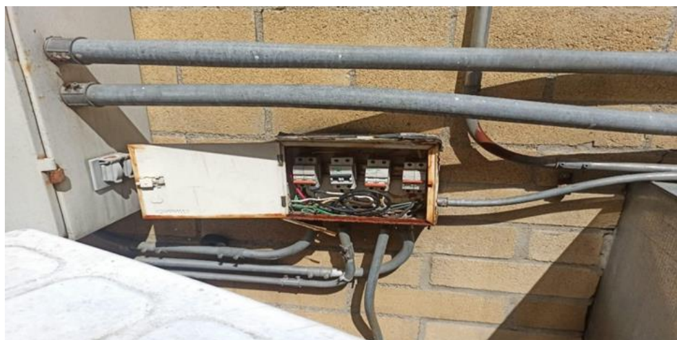
Figura 13. Tubería incorrecta, además falta marcación en caja de breaker Aire Acondicionado
