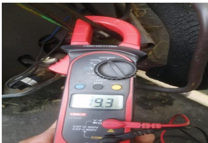
Figura 9. Mediciones caja breaker desde ML Aire Acondicionado Bloque 25 (Administrativo)
