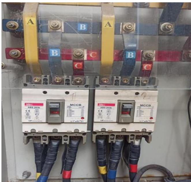
Figura 11. Falta marcación protecciones de ML Aire Acondicionado Bloque 25 (Administrativo) Fuente: diseño propio
