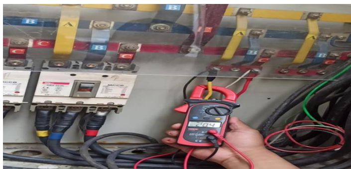
Figura 10. Falta protección eléctrica en tablero ML Aire Acondicionado Bloque 25
