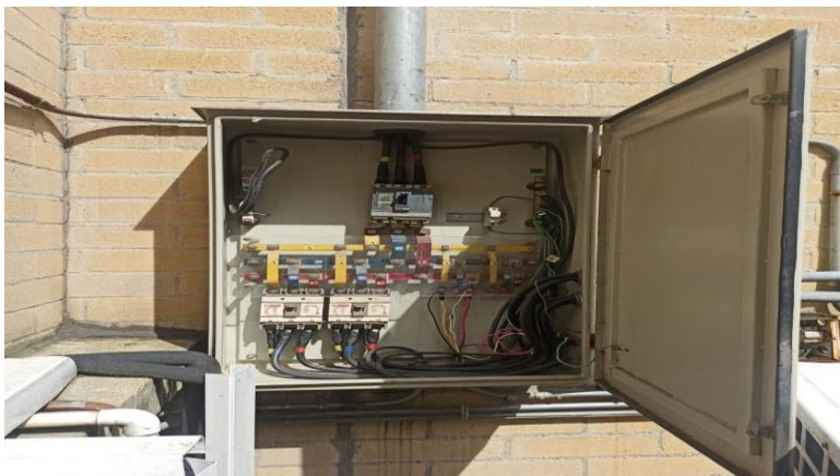
Figura 6. Tablero ML aire acondicionado bloque 25 (administrativo)
