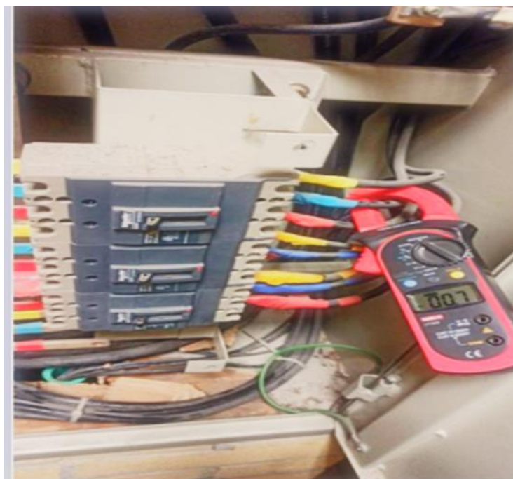
Figura 21. Corriente de tablero iluminación CIS bloque 25 (Administrativo)
