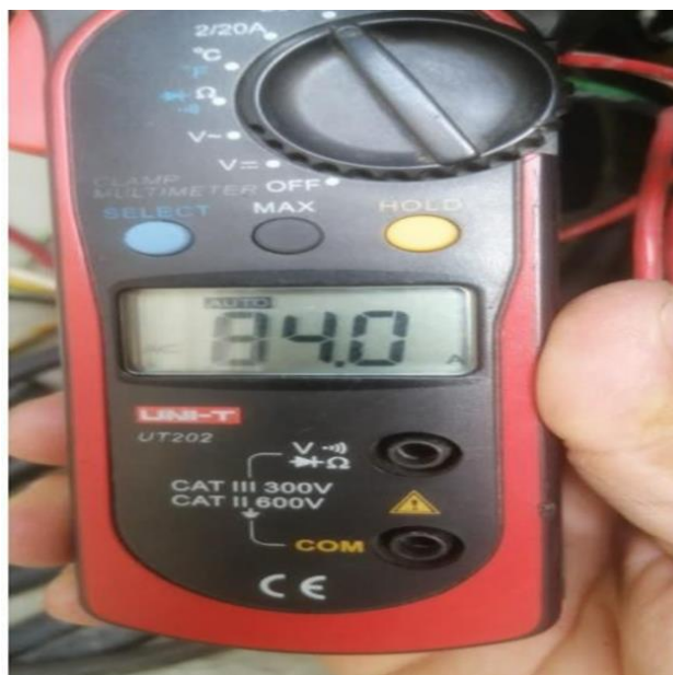
Figura 17. Medición de corriente elevada de la unidad # 2 de Aire Acondicionado bloque 25 Fuente: diseño propio
