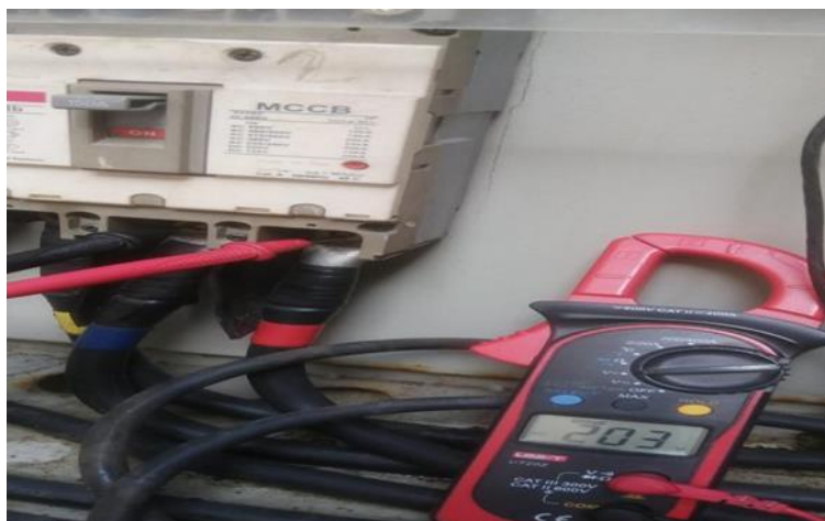
Figura 7. Mediciones eléctricas Aire Acondicionado
