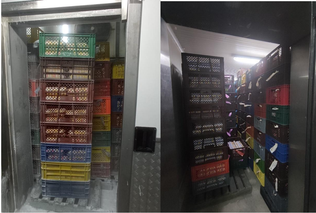
Ilustración 3. Cavas de refrigeración llenas
