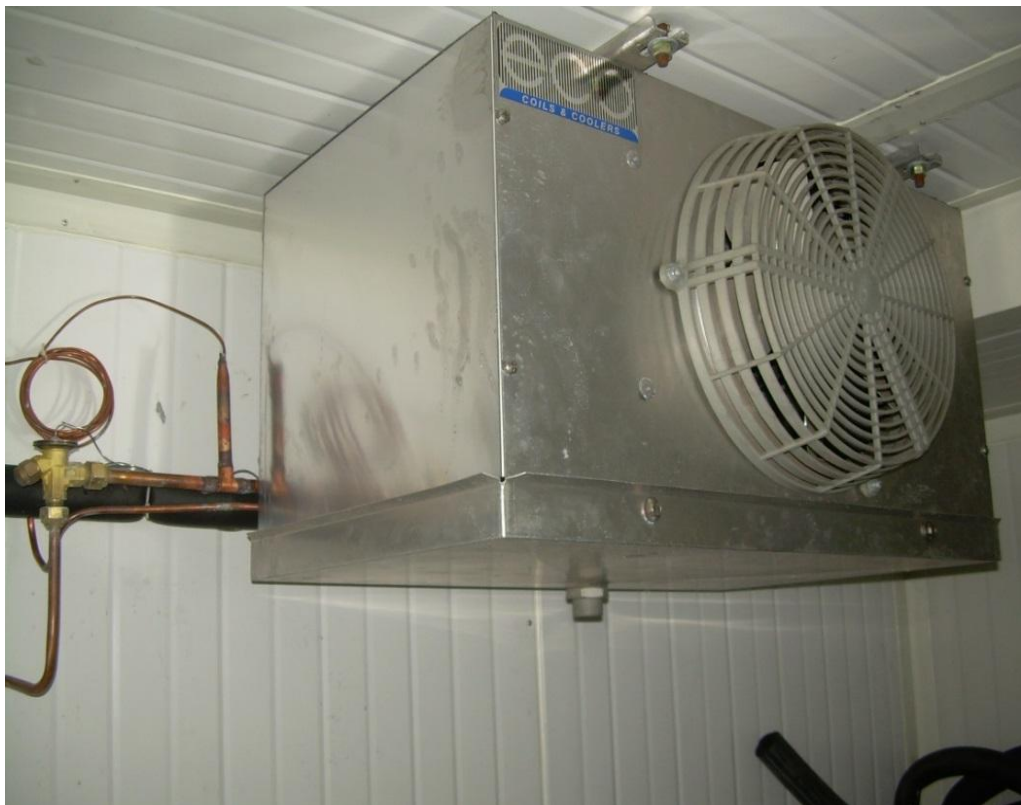
Figura 20. Evaporador Instalado en el Cuarto de Congelación.
