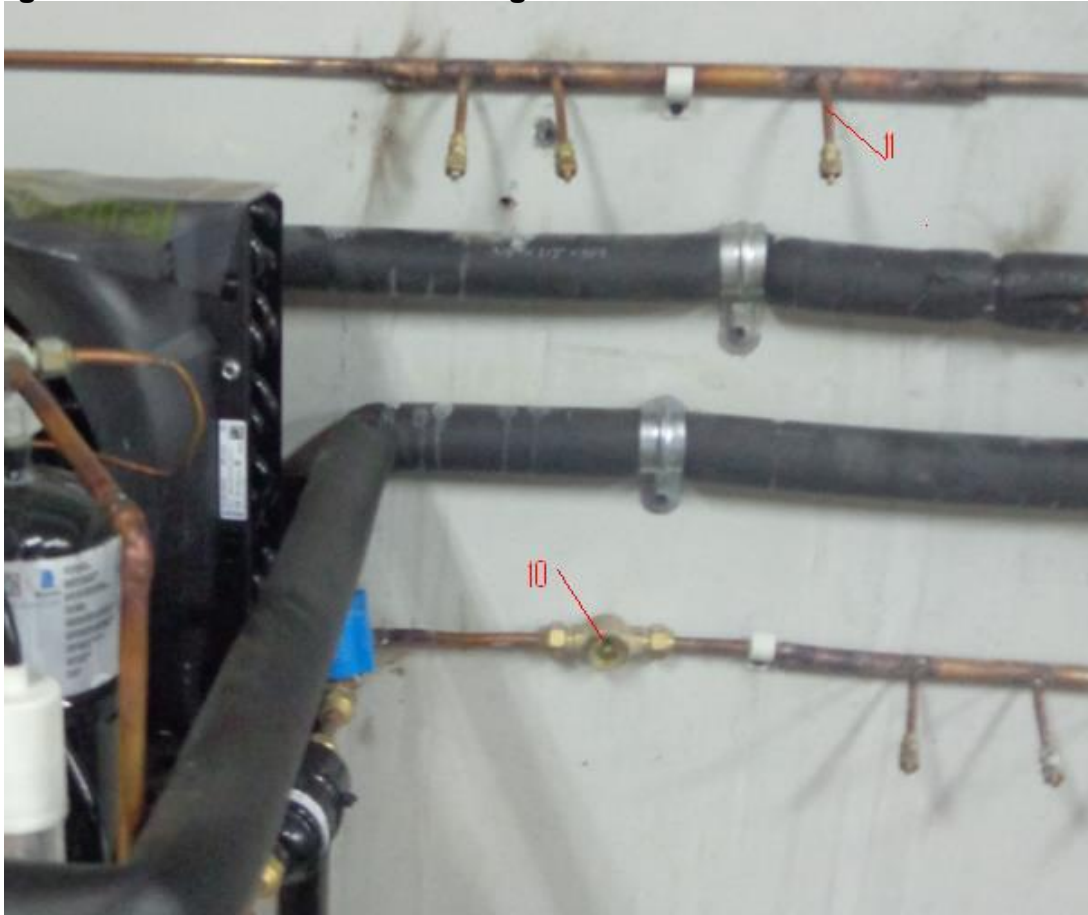
Figura 8. Tuberías sistema de refrigeración
