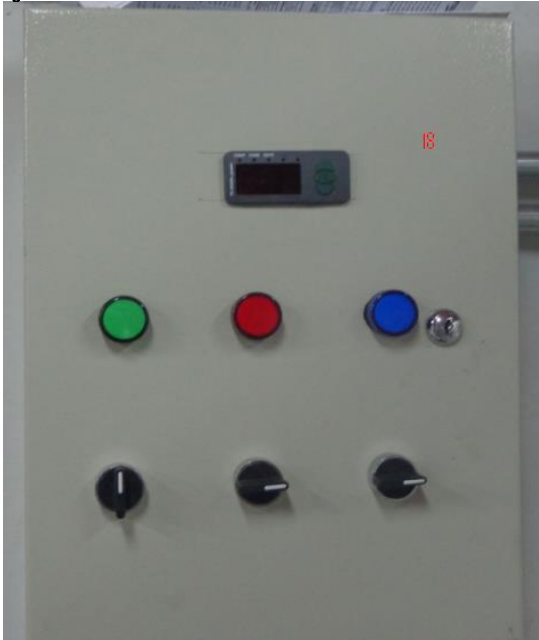
Figura 12. Tablero de control
