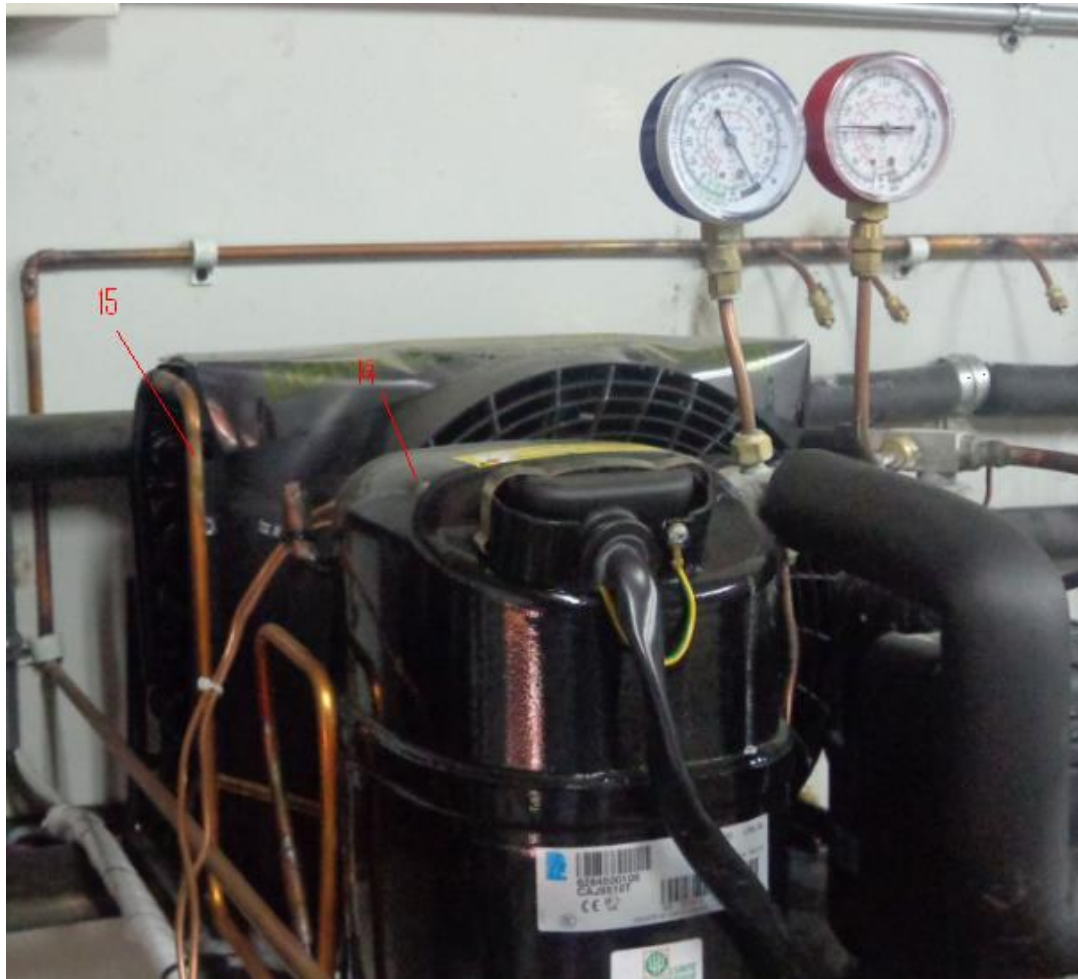
Fuente: Fotografía. Laboratorio de Refrigeración y Aire Acondicionado del IUPB. Dionis Raveles
