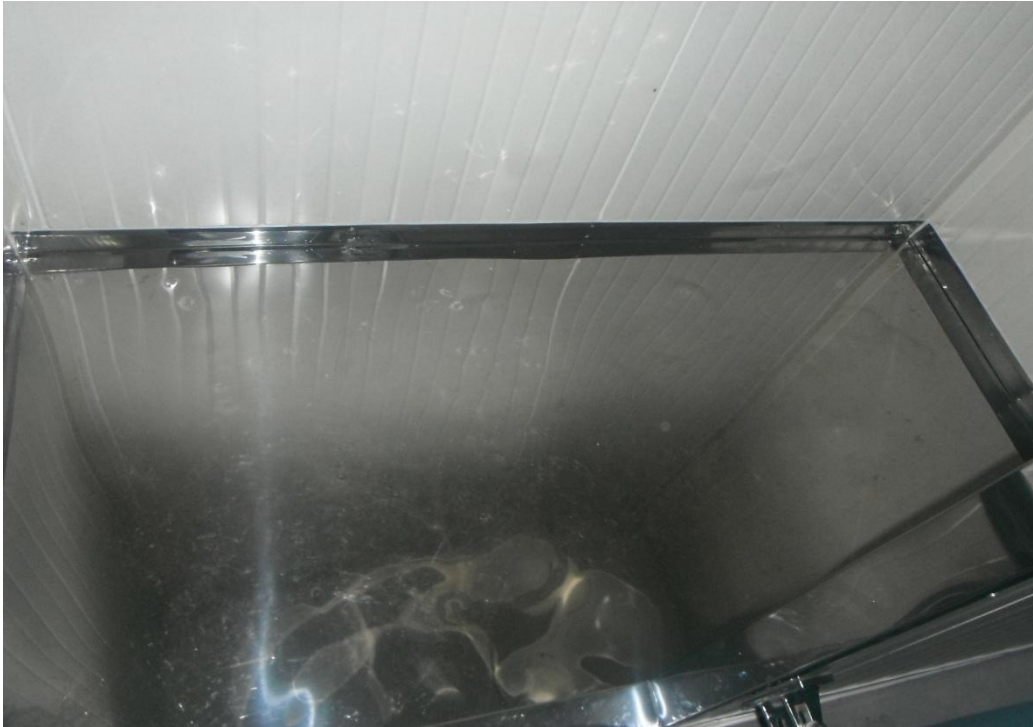
Figura 8. Piso cuarto de refrigeración.
