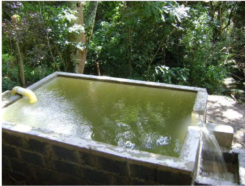
Figura 5. Tanque de almacenamiento rural de Barbosa
