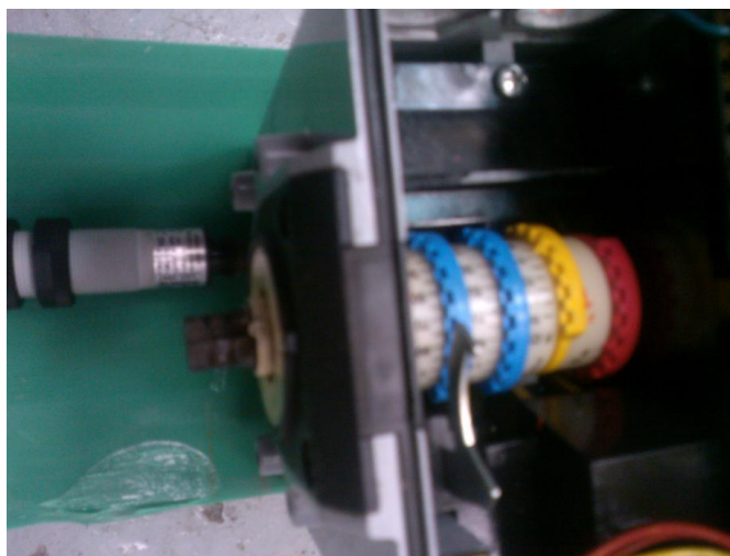
Figura 18. Sistema mecánico del Modutrol
