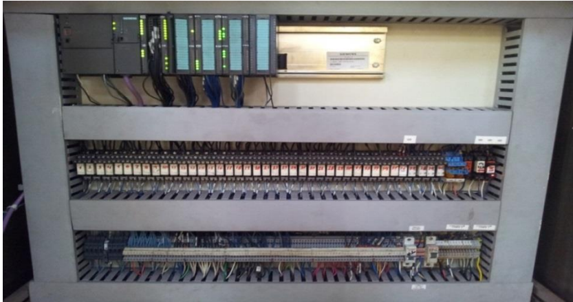
Figura 13. Antiguo tablero de control.
