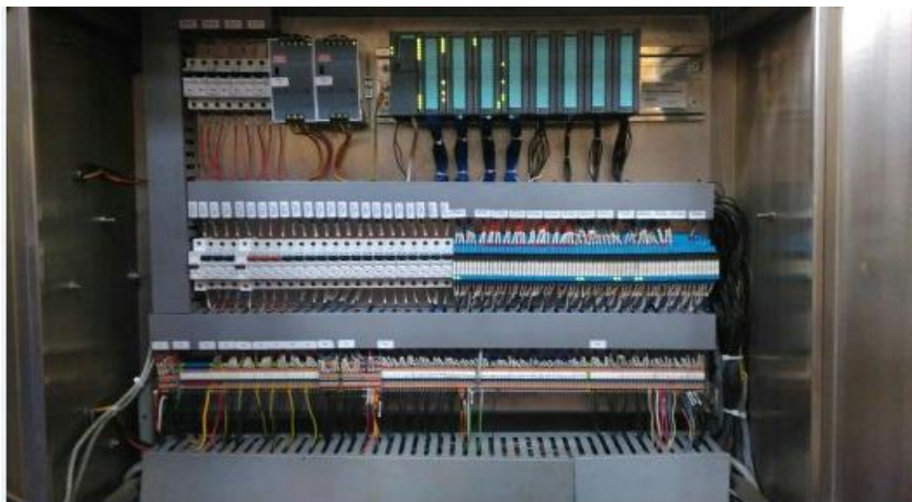
Figura 14. Nuevo tablero principal
