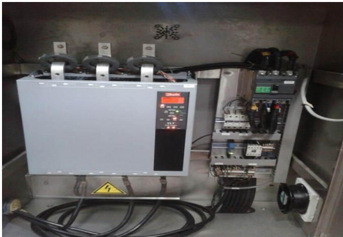
Figura 12. Nuevo sistema de arranque y cableado.
