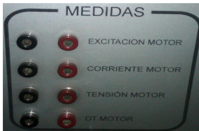
Figura 7: Bornera de conexiones de medidas a registrar.
