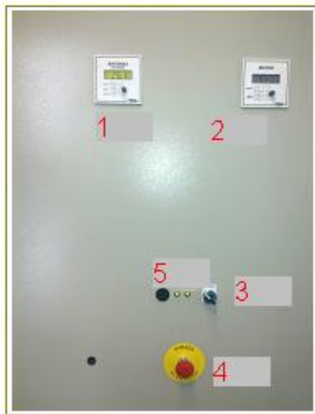
Figura 5: Gabinete de potencia de la estación Santo Domingo L
