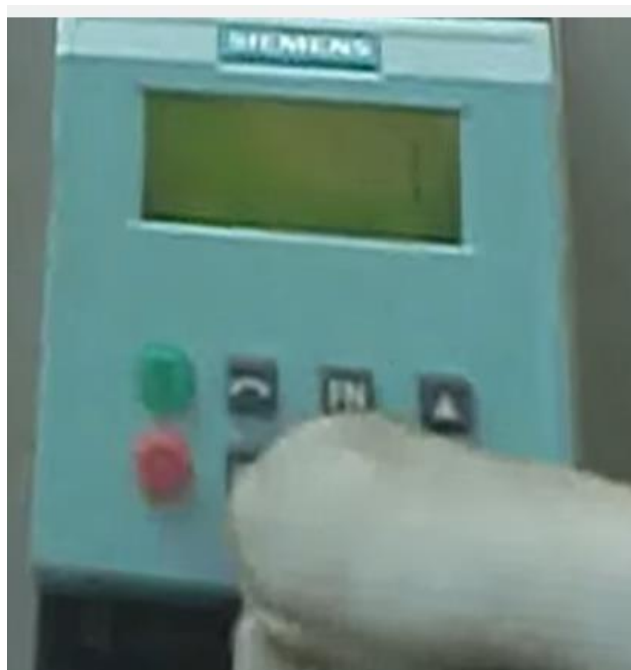
Figura 7 .Programación del variador. Imagen propia.
