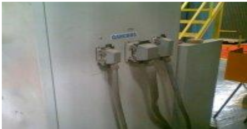
Figura 1. Vista posterior conectores ILME.
