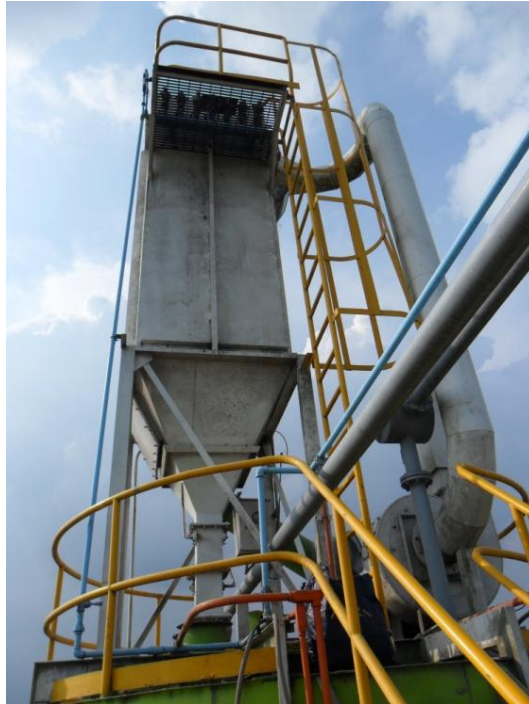
Figura 1. Colector de polvo Silo P. Galicia. Tomada de Control de Emisiones S.A.S. [11].
