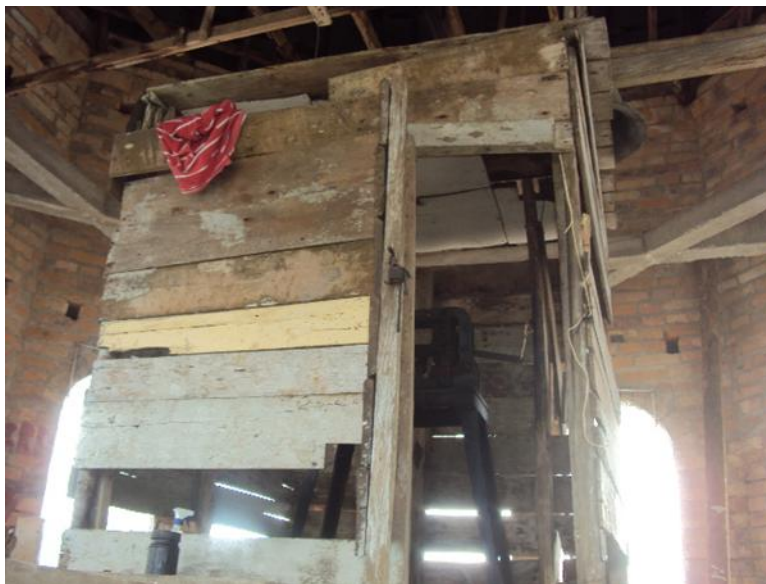
Figura 2. Estado de la cubierta de protección del reloj de la iglesia San Rafael Arcángel
