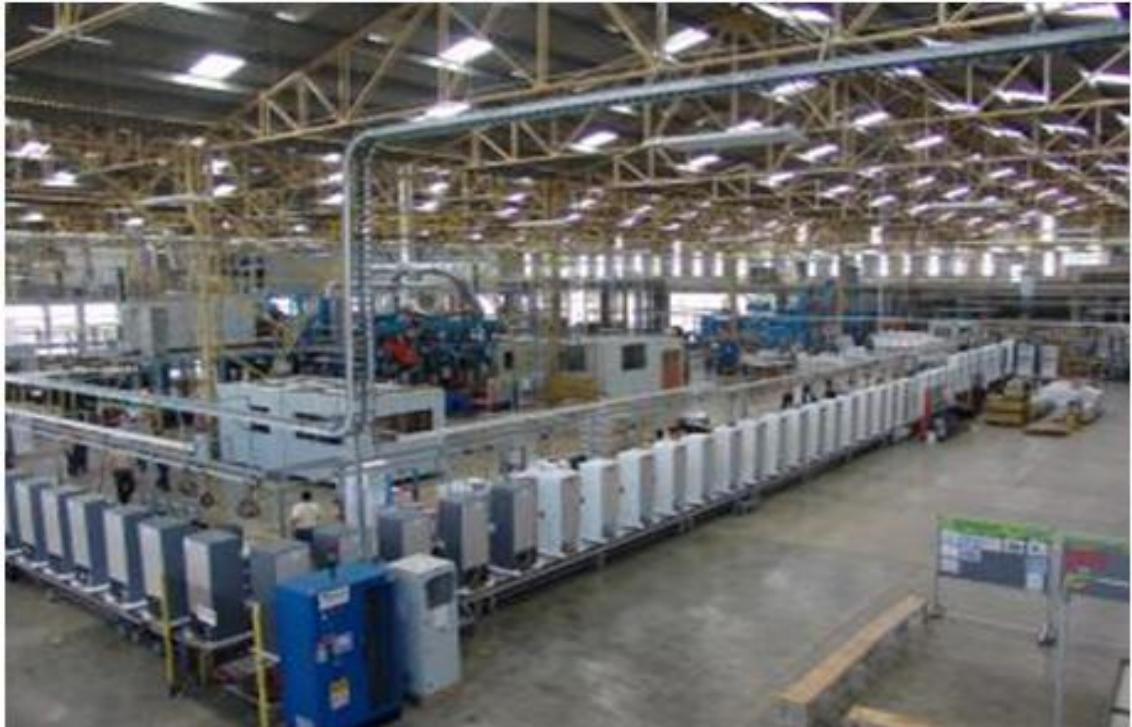
Imagen 4. Planta uno refrigeración
