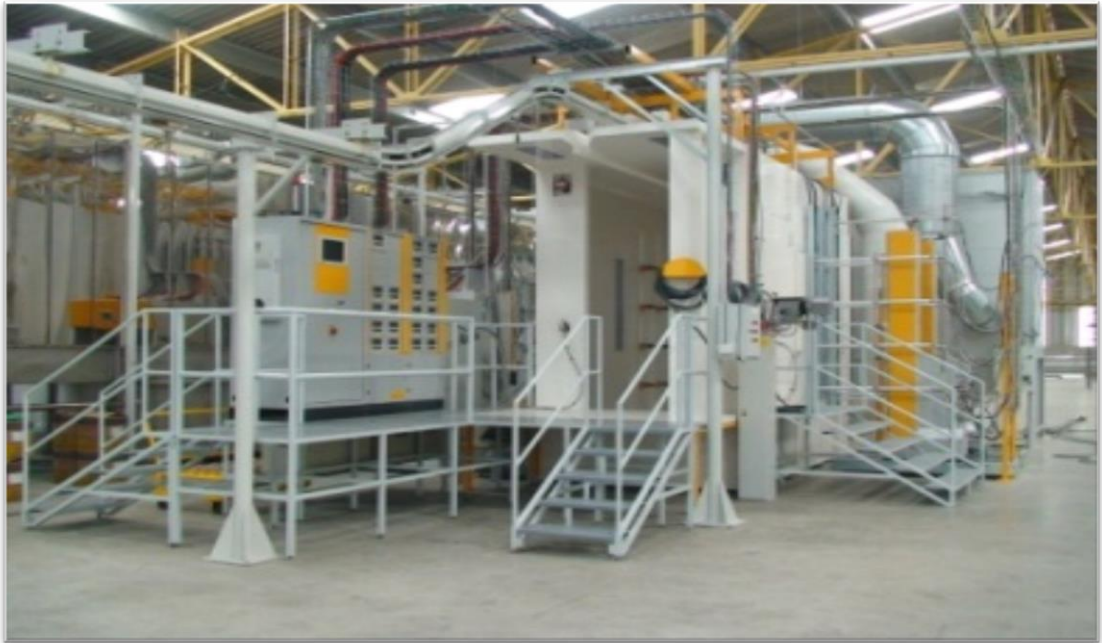
Imagen 7. Cabina automática de pintura
