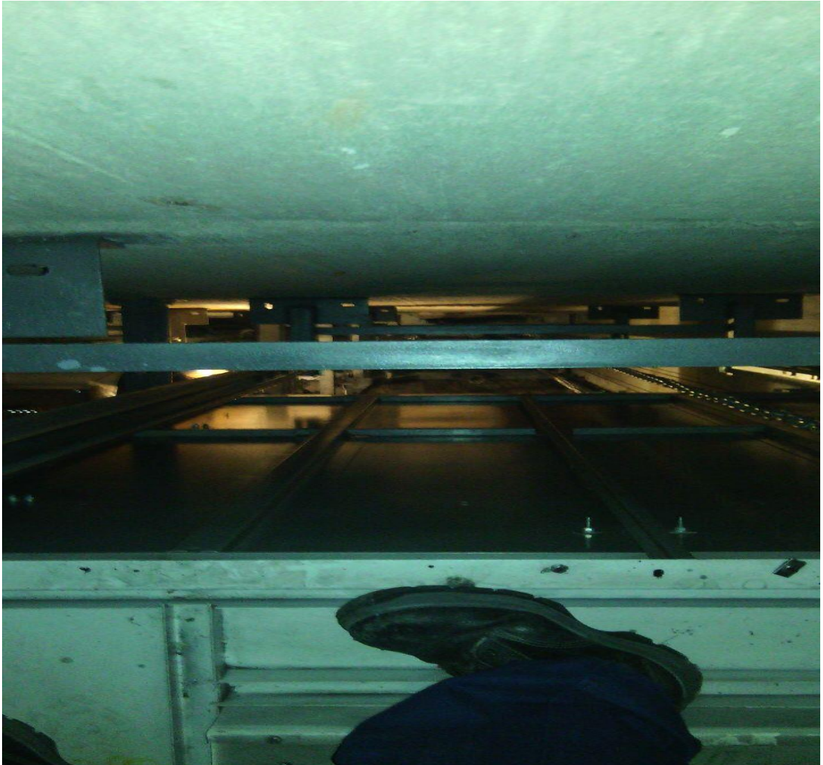
Figura 12: Vista hacia abajo del espacio existente para realizar la limpieza del ascensor
