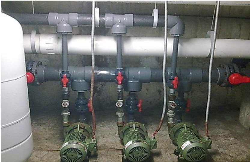
Figura 6. Vista del sistema de bombeo instalado
