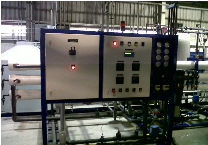
Figura 9. Tablero de control y manómetros de presión
