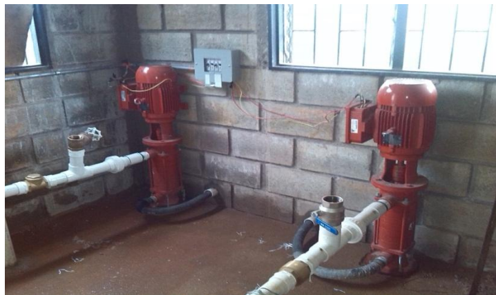
Figura 10. Cuarto de bombas
