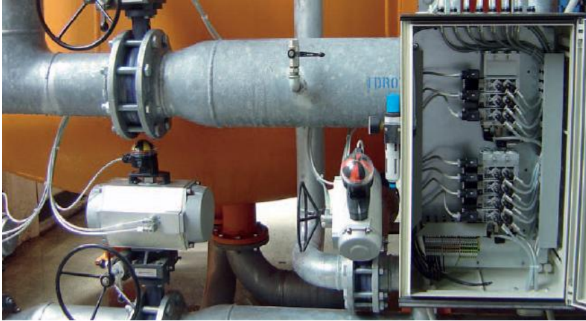
Figura 8. Sistema de bombeo automatizado
