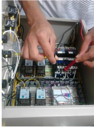
Figura 43. Medición de resistencia de bobina contactor Fuente: propia
