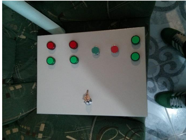
Figura 35. Pilotos luminosos y pulsadores instalados Fuente: propia
